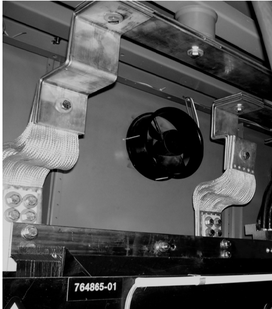
Figura 4. Conexión flexible de barras de baja tensión.
