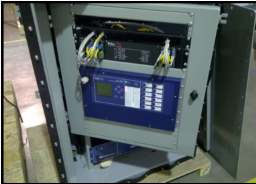
Figura 3.9 Gabinete de control de seccionador subterráneo de 4 vías operando en la DVMC.
