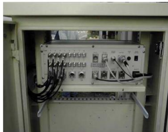
Figura 3.2 Equipo utilizado para el registro de vehículos en movimiento HI-TRAC-100
