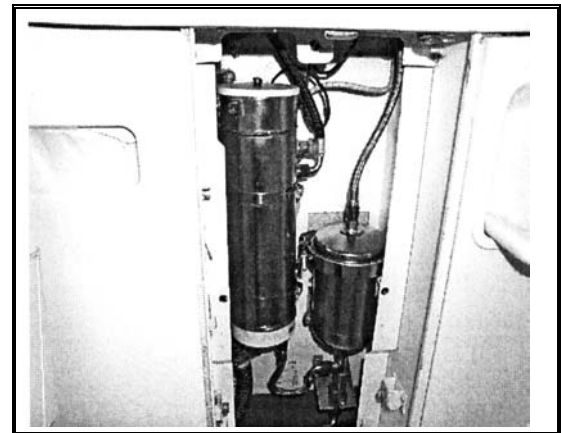
Fotografía 2. Calentador de agua.
