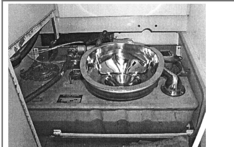
Fotografía 4. Tanque de desperdicios del sanitario.
