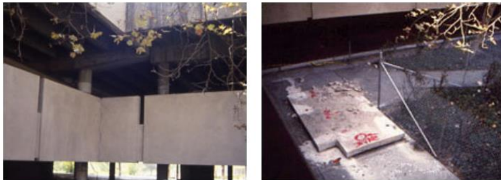
Figura 2.3 Panel prefabricado derrumbado por el sismo de Whittier de 1987 (Hutchinson et al., 2014).
