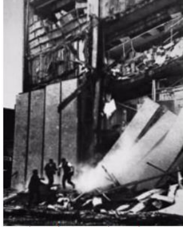
Figura 2.2 Colapso de paneles de concreto prefabricados en el sismo de Alaska de 1964 (WBDG, 2009).
