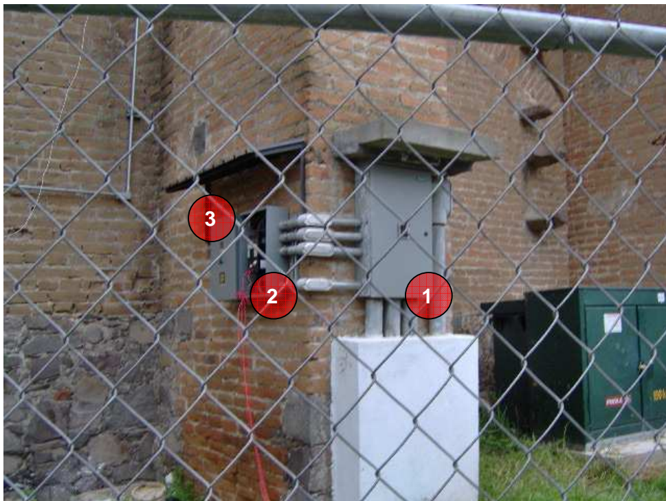
INTERRUPTORES A SUSTITUIR POR EL TABLERO GENERAL
