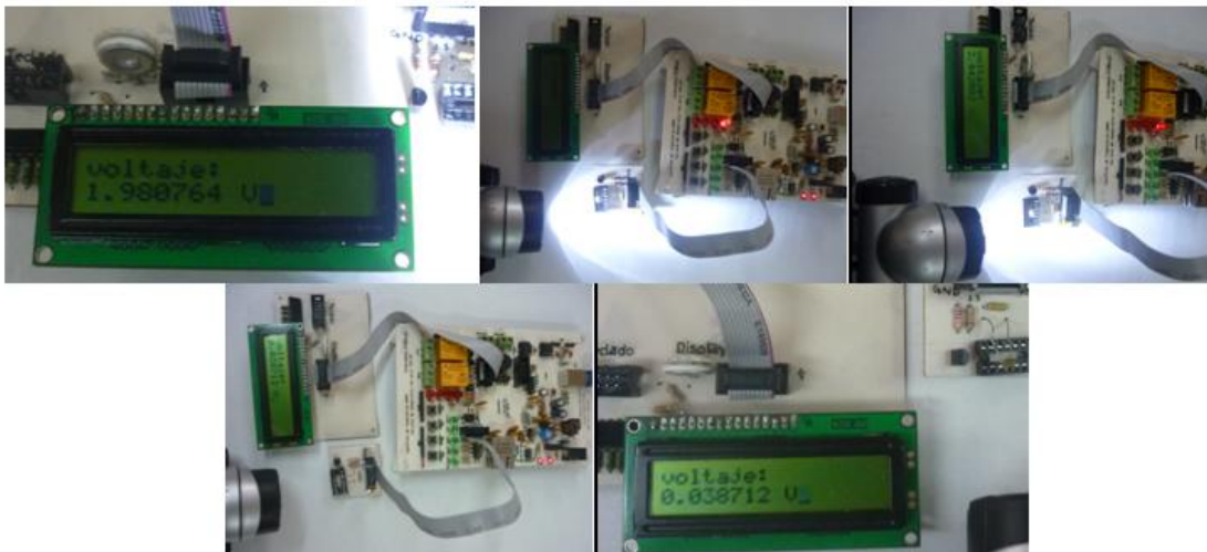
Figura 6.31 Cambio en la intensidad de luz que detecta la fotorresistencia y salidas programadas
