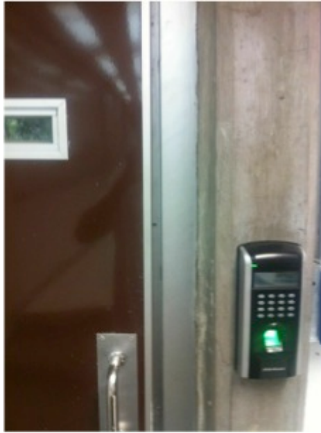
Figura 3.18 Puerta del salón J110 sin aislamiento acústico
