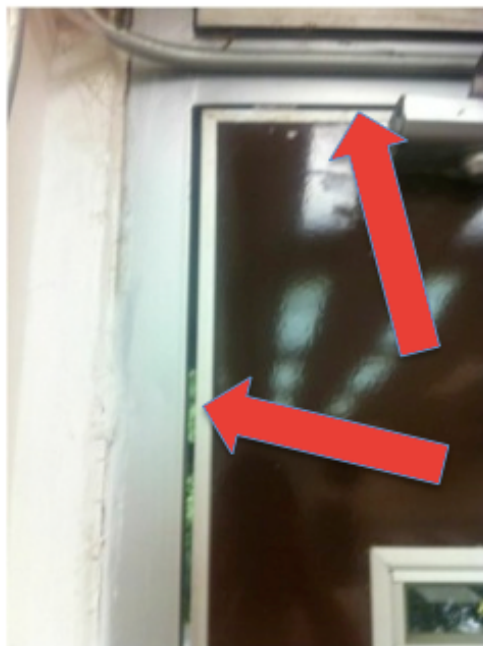
Figura 3.8 Puerta del salón D004 sin aislamiento acústico
