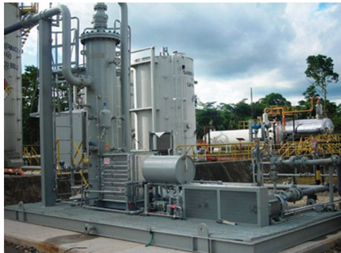
Figura 1.5: Unidades Recuperadoras de Vapor
