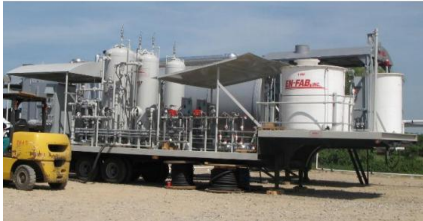
Figura 4.13 - Fotografía del generador de vapor utilizado durante la prueba piloto 1
