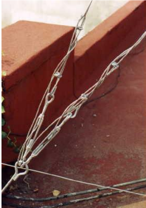
Figura 5-21 Tirantes de acero sujetos a una de las anclas
