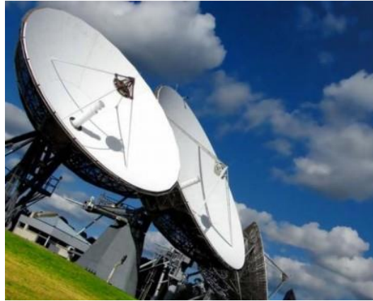
Figura 4-5 Antenas de una Estación terrena en funcionamiento
