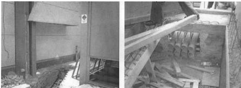
Figura 6.4. Maniobras para canalización del cableado XLP de media tensión de la nueva subestación.
