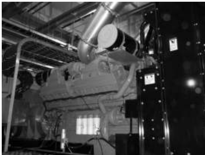
Figura 6.11. Pruebas de planta de emergencia de 2000 kW.
