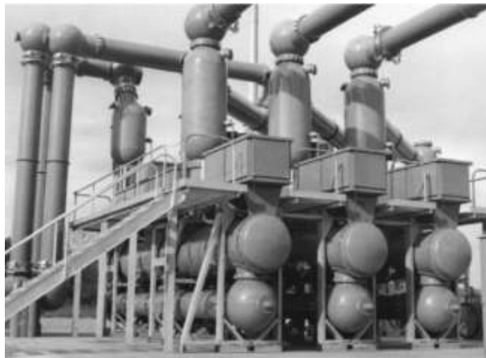
Figura 3.2 Primera Subestación GIS de 800 kV (Sistema de American Electric Power (USA)).
