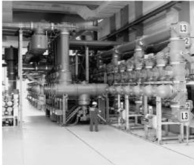
Figura 3.9 Vista de una subestación de alto voltaje aislada en gas SF 6 (GIS) del fabricante Inglés T&D en la cual se puede apreciar las ventajas en comparación con las AIS.
