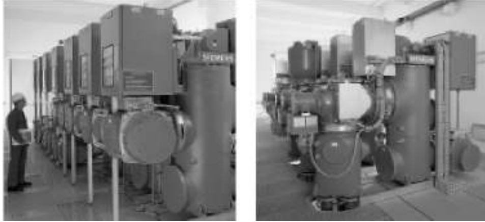
Figura 3.13. Vista en campo de la celda seccionadora 8DN8 de Siemens.
