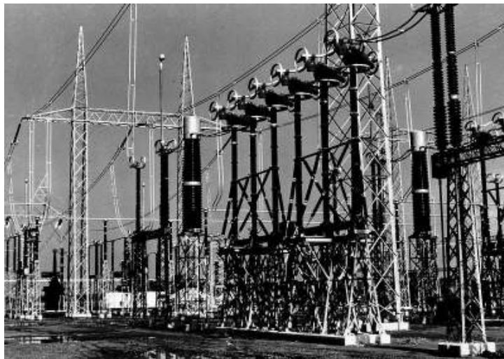
Figura 3.8. Vista de una subestación de alto voltaje aislada en aire (AIS) en la cual se puede apreciar sus dimensiones y la forma en la que está expuesta a la intemperie.
