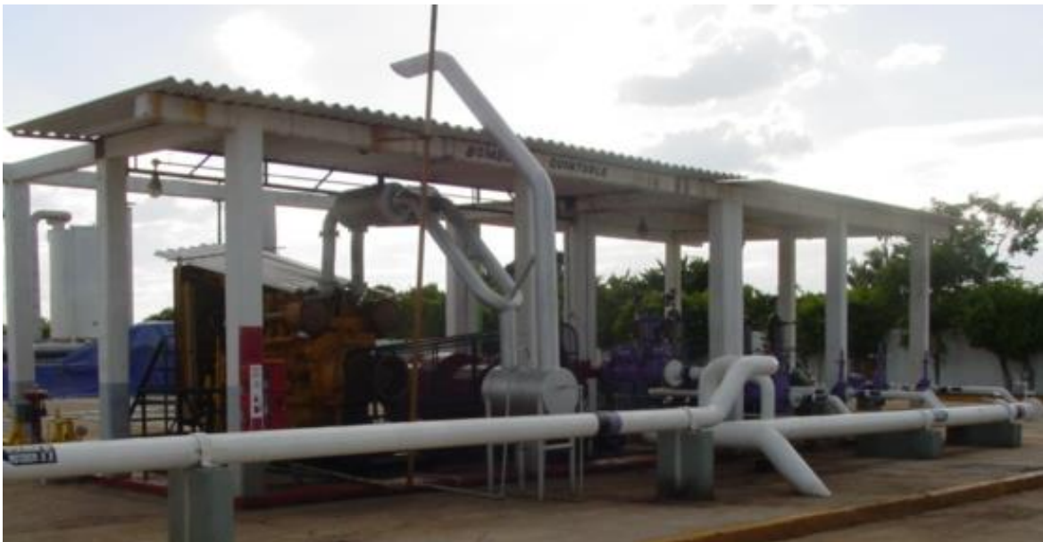
Figura V.2 Casa de bombas
