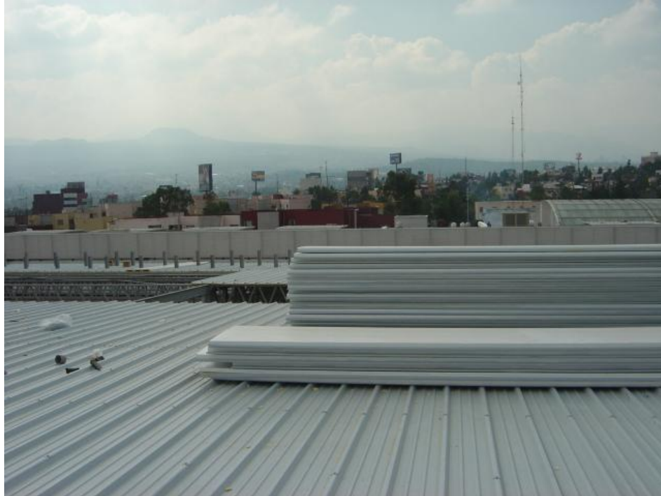
Figura 31 Instalación de panel de cubierta y modo visto desde la parte superior de la estructura metálica.
