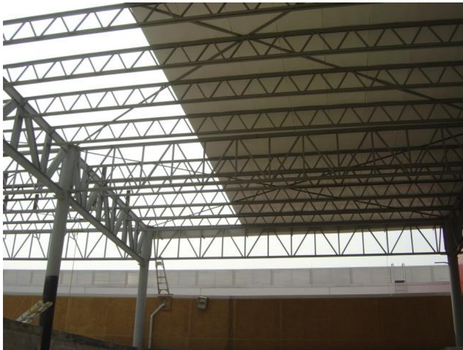
Figura 30 Colocación de cubierta en proceso vista desde el interior de la ampliación.
