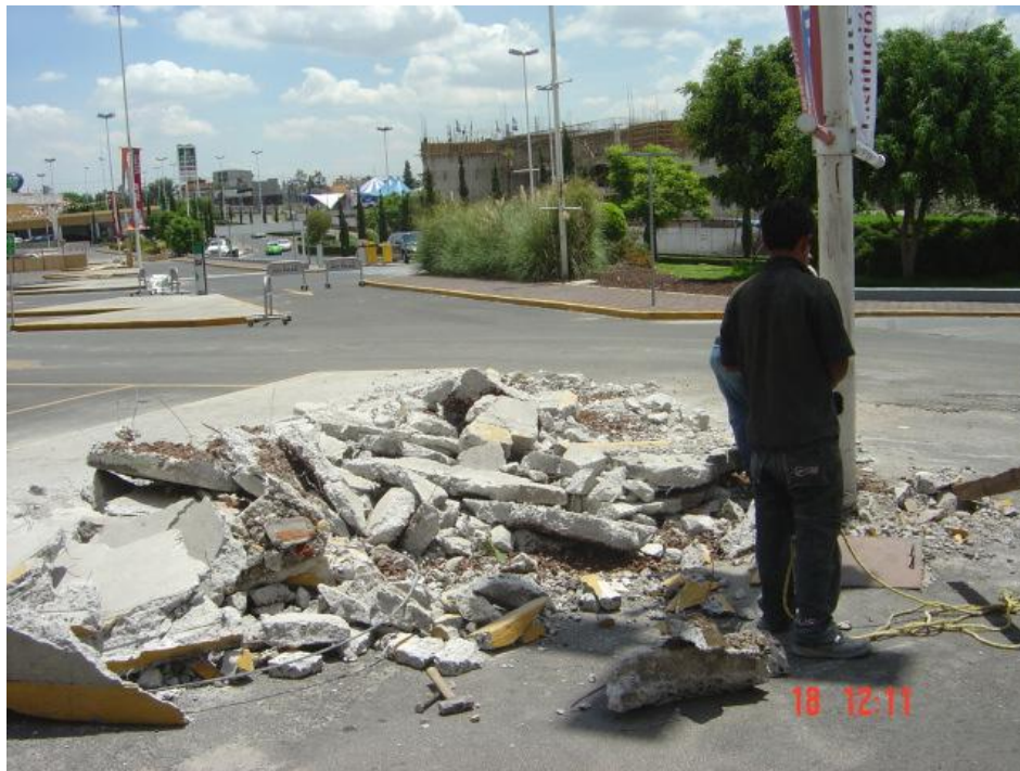
Figura 16 Trabajos preliminares. En imagen demolición de isla de concreto y desmontaje de luminaria en estacionamiento.
