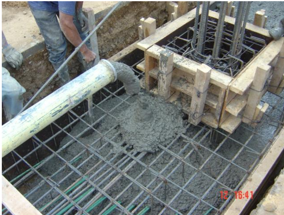
Figura 20 Colocación de concreto en zapata de cimentación. Se observa también cable de presfuerzo en la posición definitiva dentro de la zapata.
