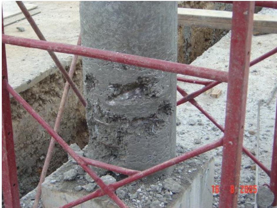
Figura 34 Vibrado deficiente en columna de concreto. El elemento se demolió y se coló nuevamente.
