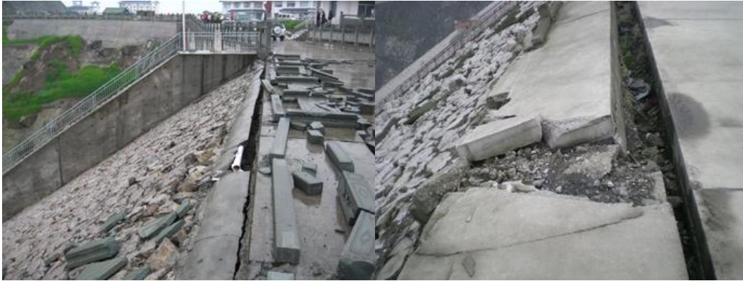
Figura 2-6 Presa Zipingpu: Daños en la cresta (vista aguas abajo)
