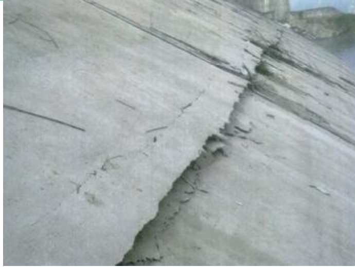
Figura 6-1 Daños en la cara de concreto de la presa Zipingpu ECCC (Fotografía cortesía ZepingXu, China) Tomadas de la presentación del Dr. Martin Wieland en el "The First International Symposium on Rockfill Dams", en Chengdu, China del 18 -21 de octubre 2009
