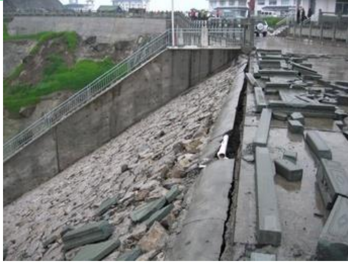
Figura 6-3 Daños en la cresta (bordo aguas abajo) de la presa Zipingpu ECCC (Fotografía cortesía ZepingXu, China) Tomadas de la presentación del Dr. Martin Wieland en el "The First International Symposium on Rockfill Dams", en Chengdu, China del 18 -21 de octubre 2009
