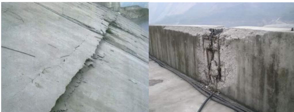
Figura 2-5 (i) Daños en la cara de concreto (d) Daños en el parapeto de la presa Zipingpu
