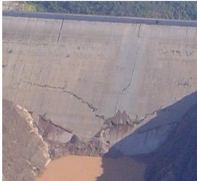
Figura 4-17 Fracturamiento en la presa "Campos Novos" en Brasil presentando durante su primer llenado (2006)
