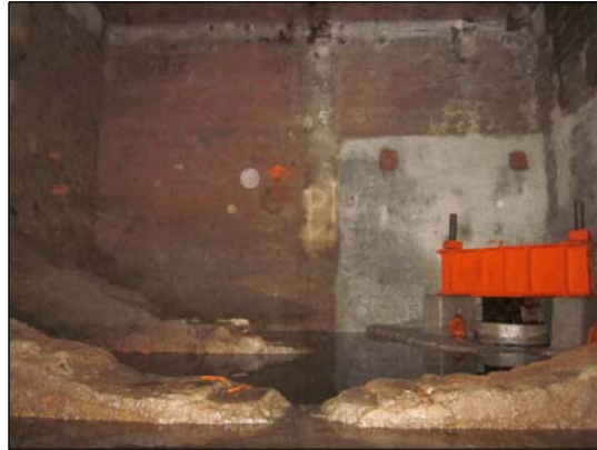
FIG. 1.2 SISTEMA DE PILOTES DE CONTROL INSTALADO EN EL INMUEBLE
