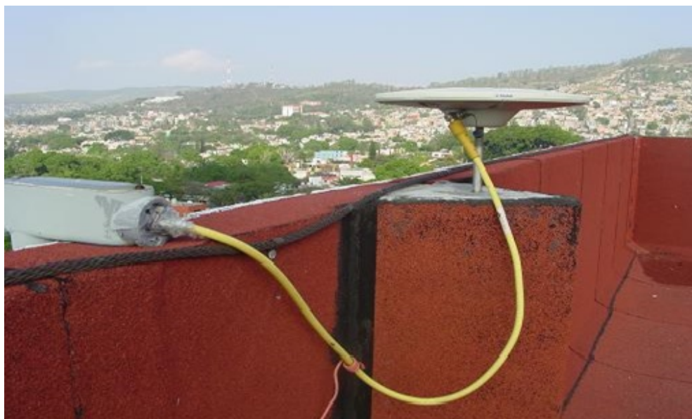
Foto estación OAX2 de la Red Nacional Geodésica Activa de la ciudad de Oaxaca, Oax.
