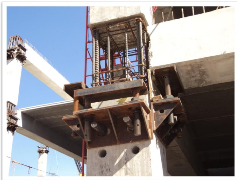
Figura 2.12. Ménsula metálica temporal, es ajustable y reutilizable, se puede retirar una vez que el colado del nodo ha alcanzado la resistencia de proyecto.
