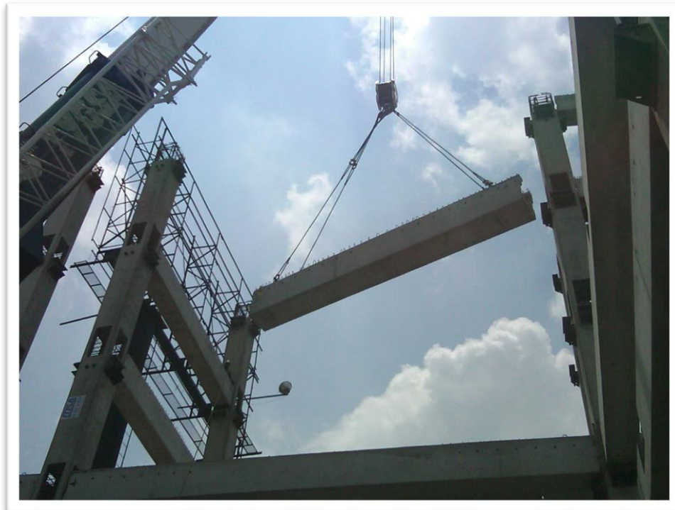
Figura 4.41. En esta imagen observamos los trabajos de izaje y alineación de las traves (portantes y rigidez) en las ménsulas metálicas.
