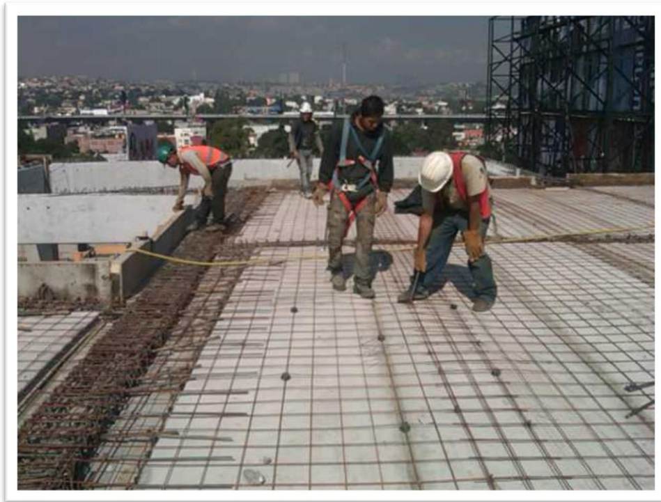
Figura 4.65. Durante la colocación de la malla electrosoldada se calza con silletas plásticas para ubicarla en el lecho donde se necesita el refuerzo.
