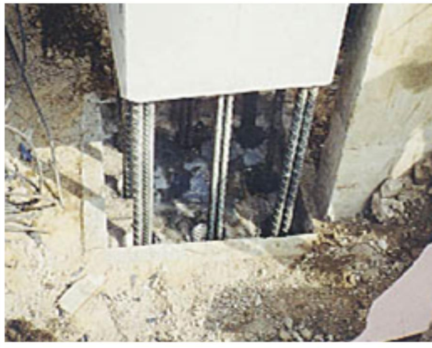
Figura 2.9. Montaje de columna insertando armado en ductos de cimentación. Proyecto: nave electrólisis Peñoles.
