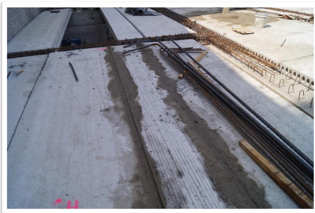
Figura 4.62. La función del colado de llave de cortante o "Junteo" es que las losas trabajen en conjunto.
