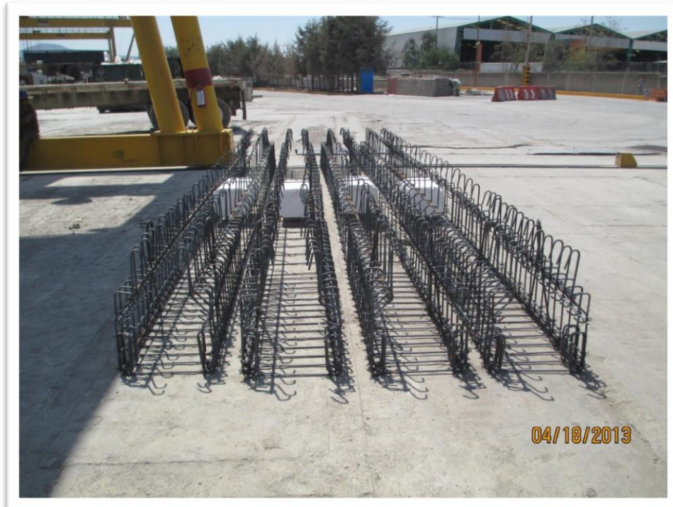
Figura 4.9. Los trabajos de habilitado y armado de acero de refuerzo de las traveses se puede iniciar simultáneamente con los trabajos de adecuación en las líneas de producción.
