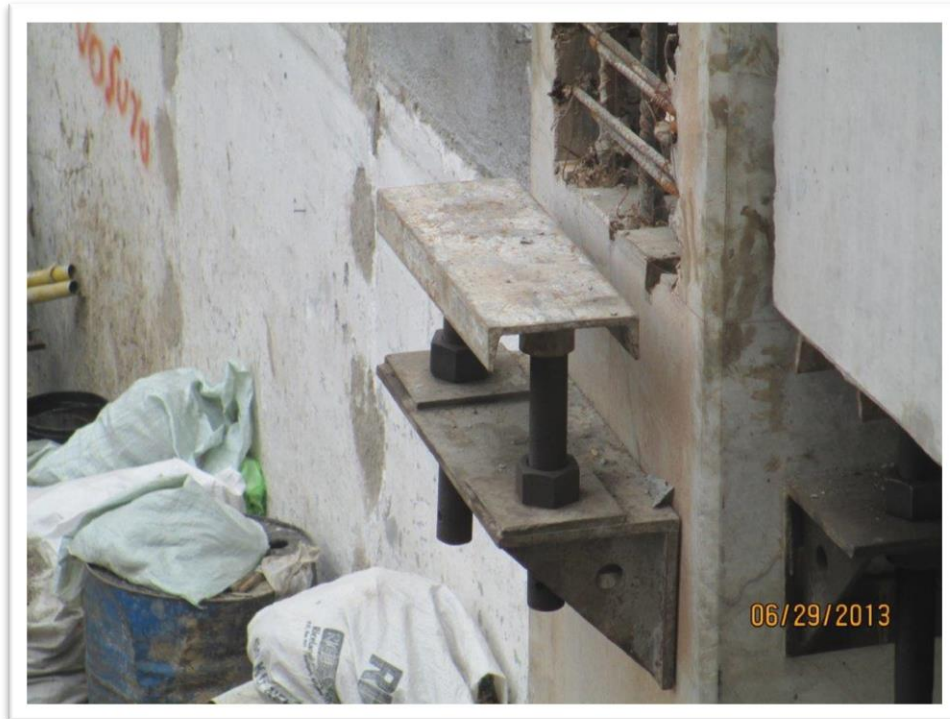
Figura 4.40. Previo al montaje de las traves se deben colocar y nivelar las ménsulas metálicas temporales.
