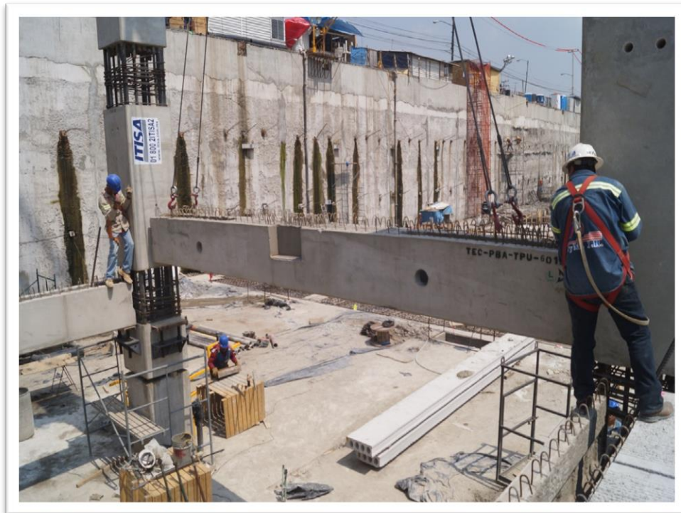
Figura 2.54. Trabajos de montaje de traveses tipo TPU. Proyecto: Centro comercial Azcapotzalco Ciudad de México (2014).
