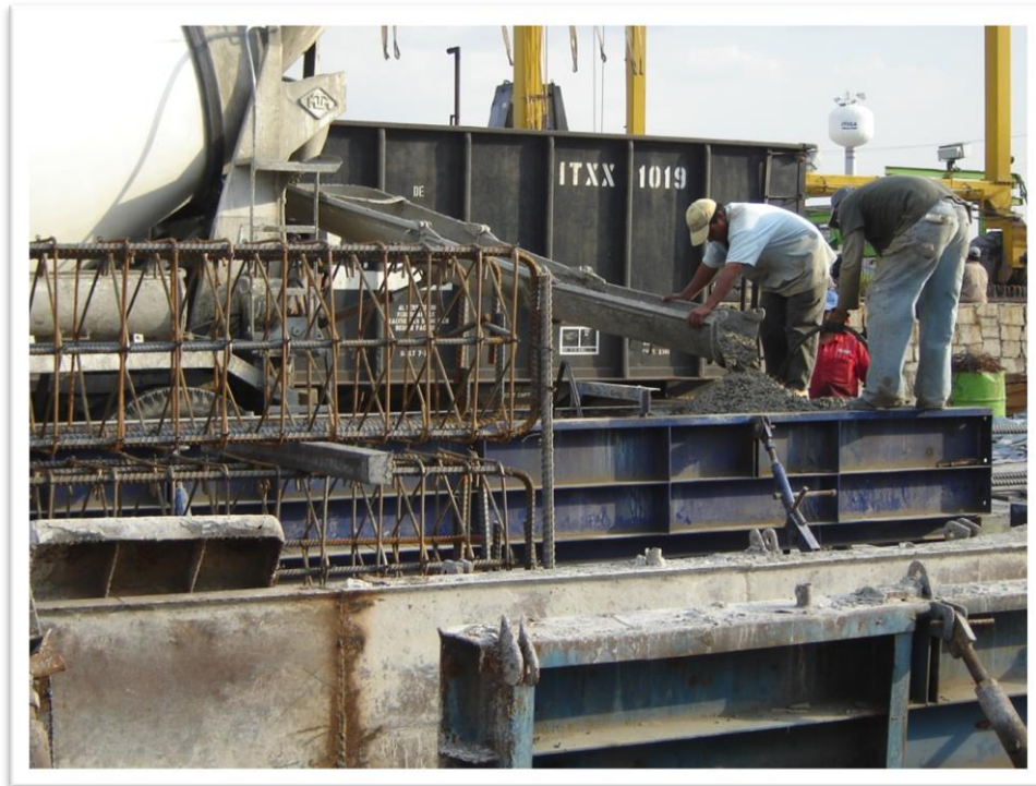
Figura 4.14. El colado de las traveses se realiza con concreto de resistencia rápida, en este caso con un 80% de su resistencia nominal a las 14 horas con el fin de poder destensar al día siguiente y habilitar la siguiente línea de colado.
