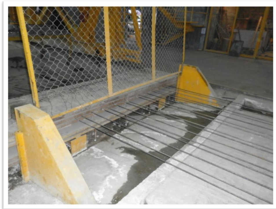
Figura 4.15. Las líneas de colado de losas alveolares están habilitadas exprofeso para esta actividad, la primera actividad para el colado de la línea es la colocación y tensado de los cables de presfuerzo a todo lo largo de la línea.
