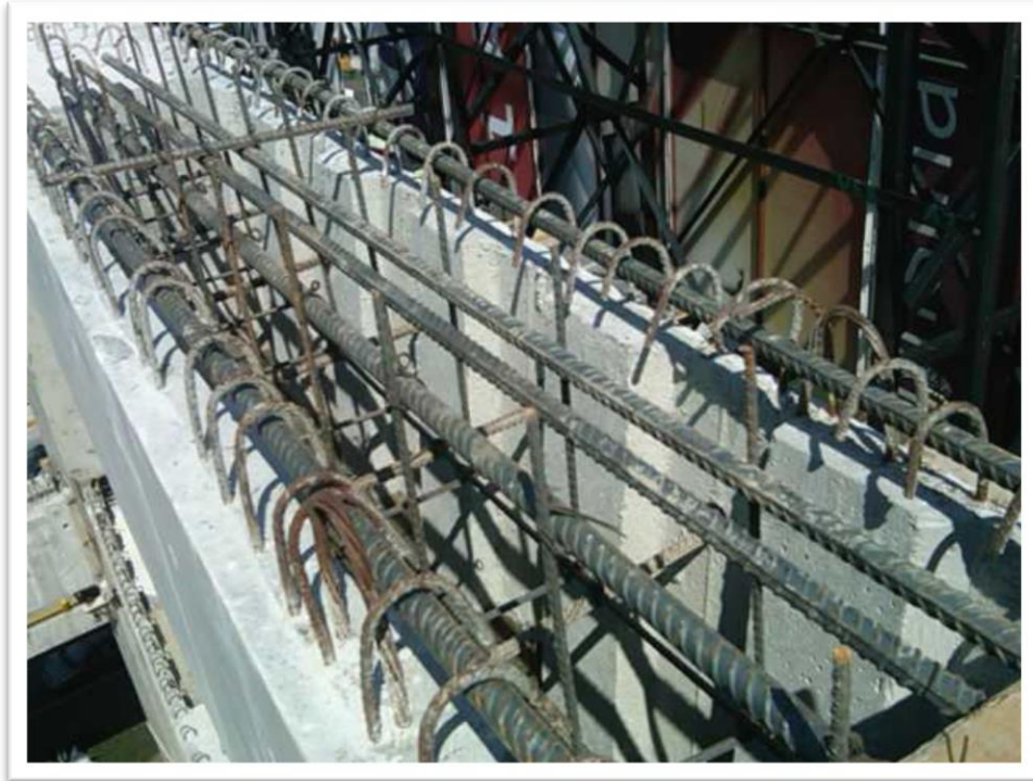
Figura 4.53. En estas imágenes se observa el armado de continuidad superior en las secciones "u" de las trabes.
