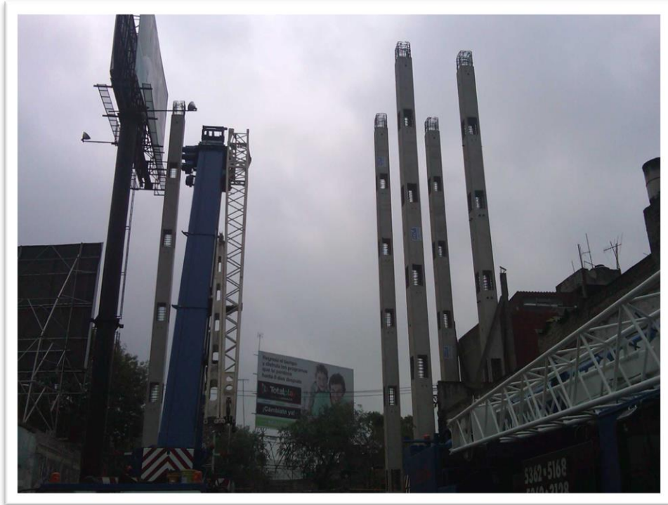
Figura 4.38. Para el caso de esta estructura se decidió que se montarían primero la totalidad de las columnas (14 piezas) para resolver el tema del poco espacio con que se contaba para su montaje.
