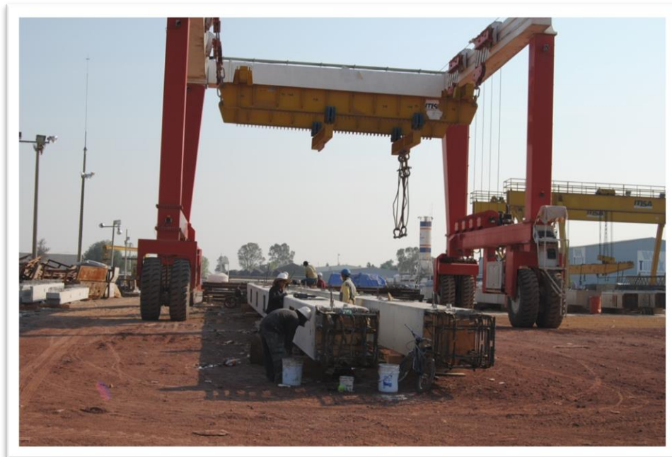
Figura 4.5. Al siguiente día del colado se puede desmoldar el elemento y ser transportado hasta el patio de almacenaje esperando su turno para ser embarcado.
