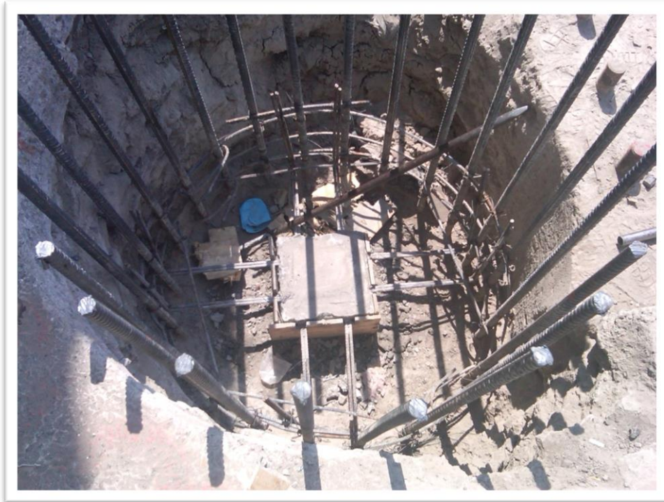
Figura 4.45. Después de colar la pila y una vez descabezada en la longitud recomendada, se coloca la placa niveladora y se realiza un colado secundario sobre la pila para que se pueda apoyar el perno de la columna sobre la misma.
