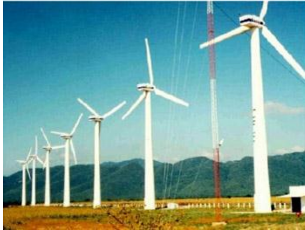
Figura 2.9 Central Eólica La Venta – Oaxaca.
