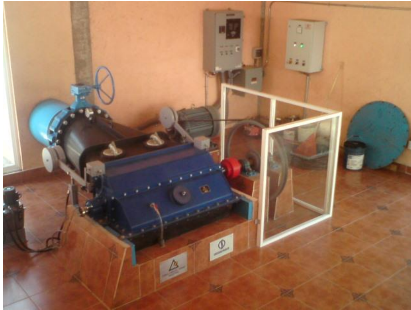
Foto A2-13 Vista general de arreglo de cuarto de máquinas operando.
