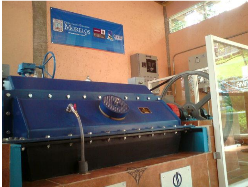
Foto A2-15 Vista de turbina y tableros antes de inauguración.
