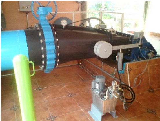
Foto 5.1.5 Válvula y toma de agua
