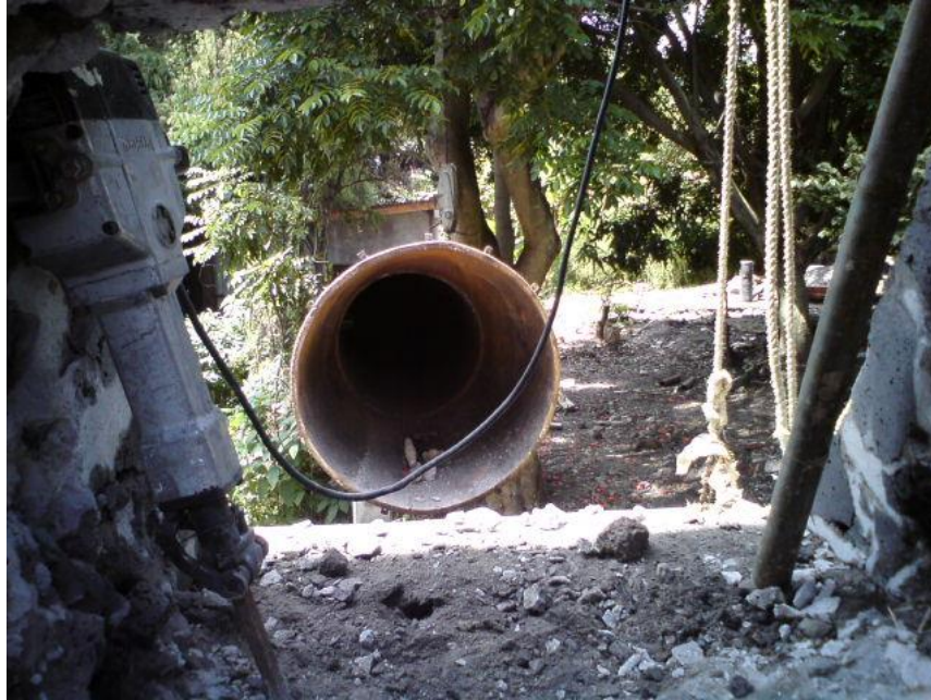
Foto A2-09 Vista de cono de entrada (toma) desde hueco en cortina.
