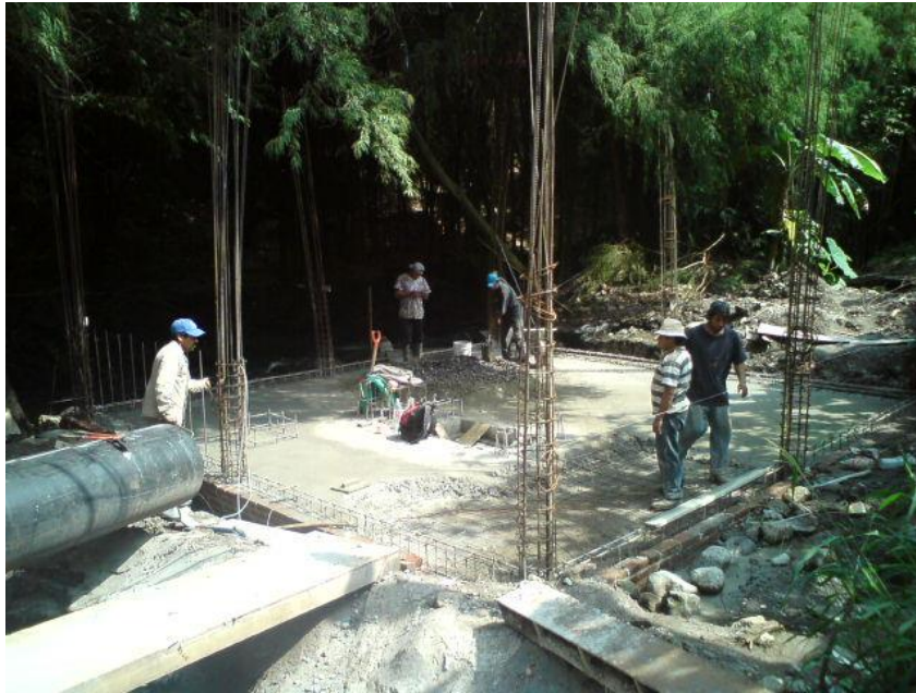
Foto A2-06 Vista de losa tapa de canal de desfogue, piso y desplante de columnas.
