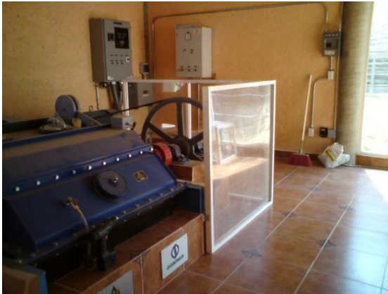
Foto 5.1.3 Turbina y polea
