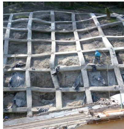
Concreto lanzado- Estabilidad de taludes Método Grid Beam System (Ciudad Numazu; prefectura Shizuoka, Japón)
