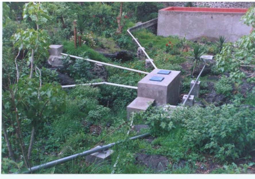
Figura 3.2c Fotografía de los sedimentadores primarios del humedal artificial de flujo vertical localizado en la Zona Cultural de la Ciudad Universitaria
