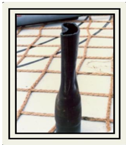
Colapso de una tubería
