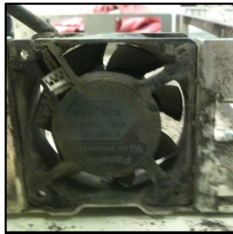
Figura 4. 6 Ventilador del switch
