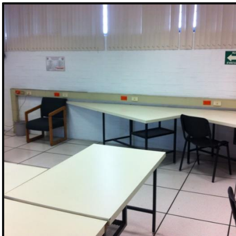
Figura 2. 4 Canaleta expuesta de área de trabajo
