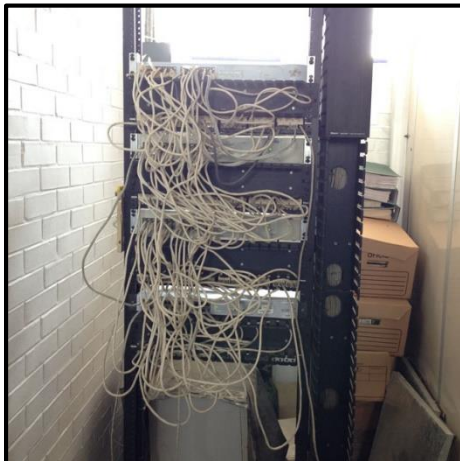
Figura 2. 18 Rack y cableado de patch panel - switch
