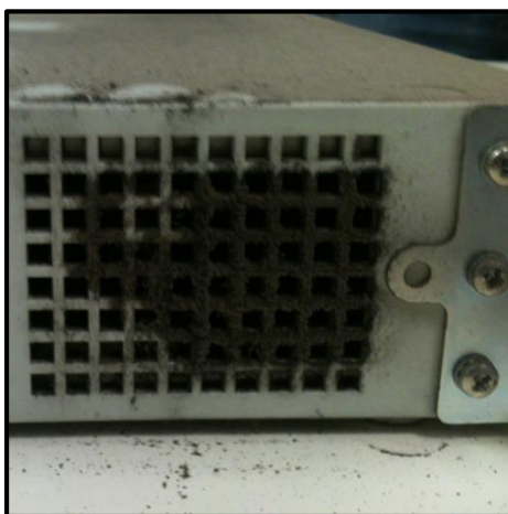
Figura 4. 7 Orificios de ventilación obstruidos por el polvo
