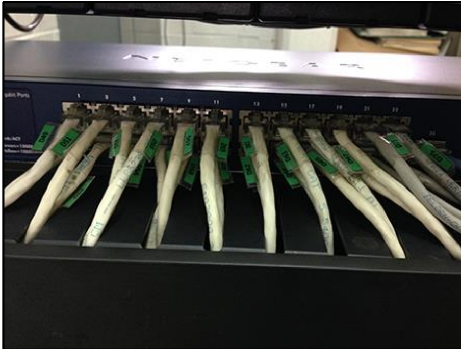
Figura 6. 8 Etiquetado de conexiones del tercer switch
