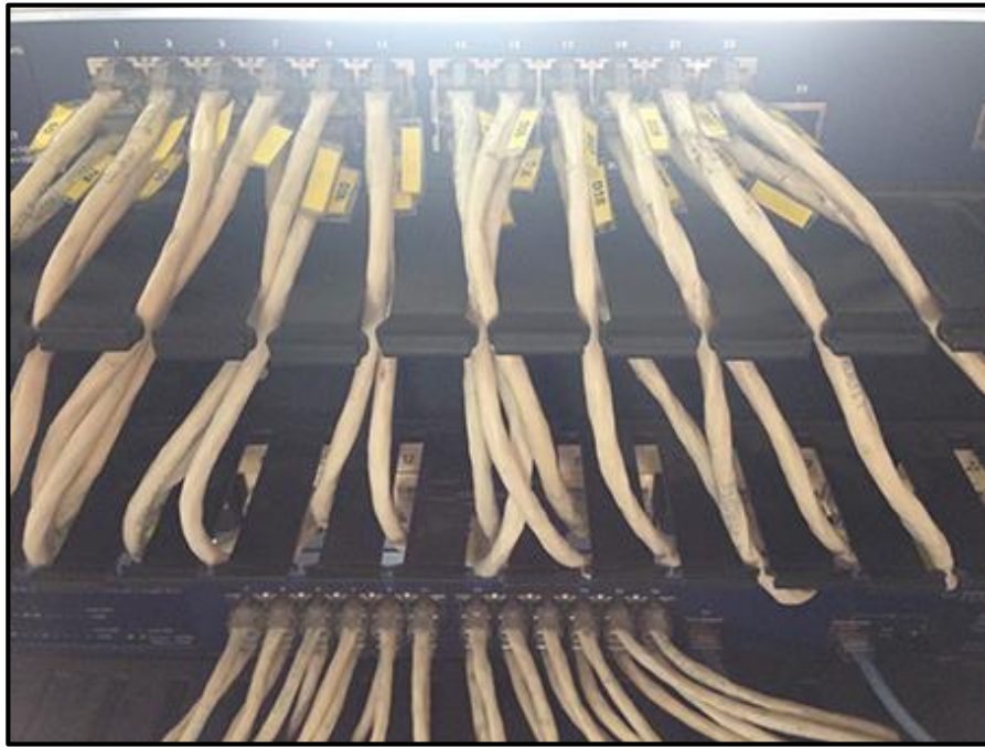
Figura 6. 6 Etiquetado de conexiones del primer switch
