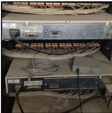
Figura 2. 20 Switches y cableado de patch panel
