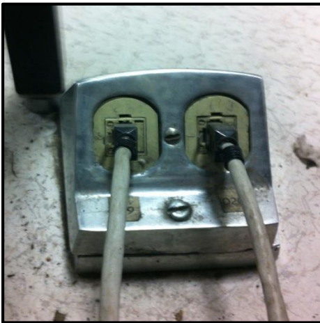
Figura 2. 12 Roseta de piso
