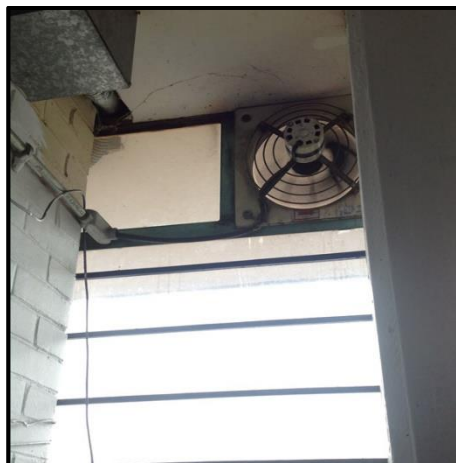
Figura 2. 23 Sistema de ventilación único
