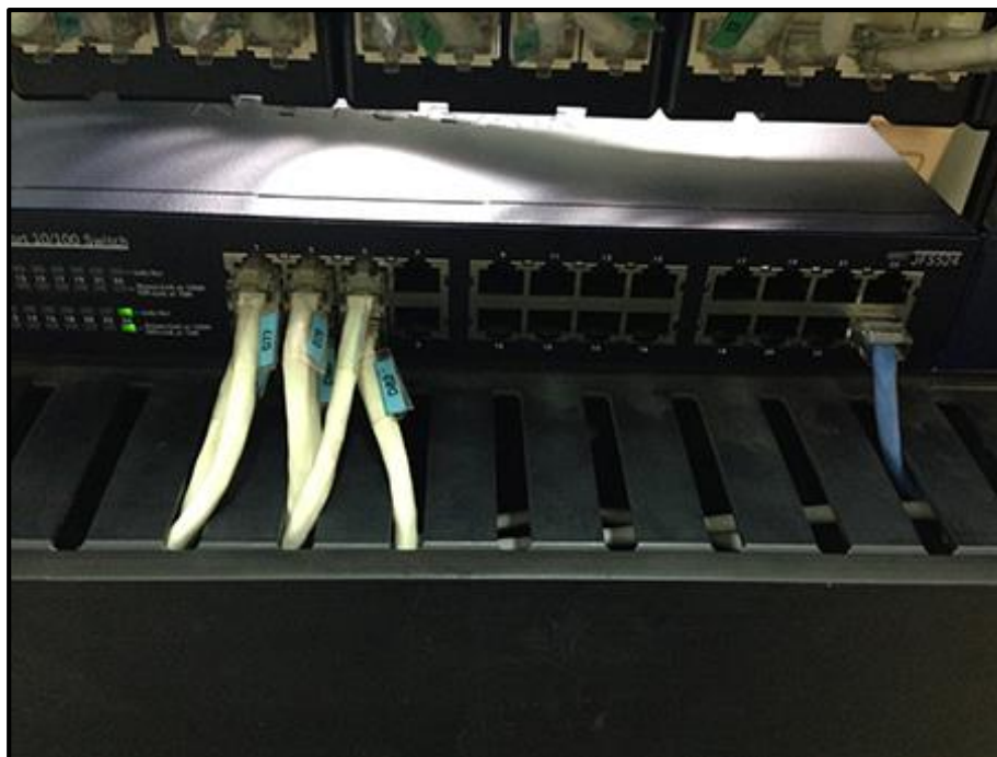
Figura 6. 9 Etiquetado de conexiones del cuarto switch
