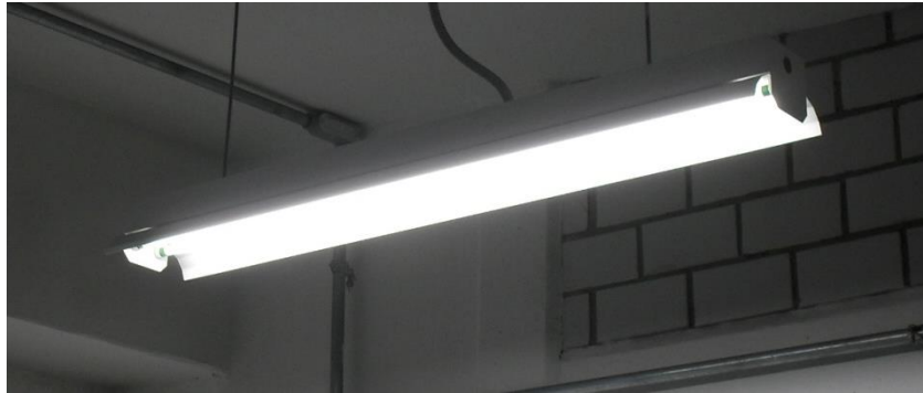
Imagen 2.7 Luminaria en la subestación.
