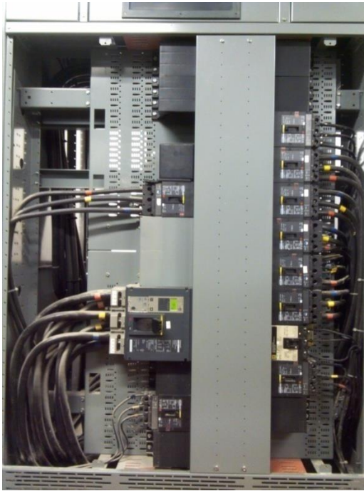
Imagen 2.11 Tablero general subestación.
