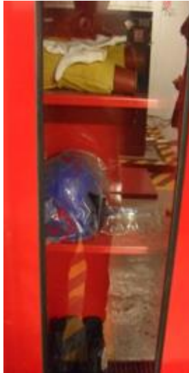
Imagen 2.6 Equipo de seguridad en la S.E.
