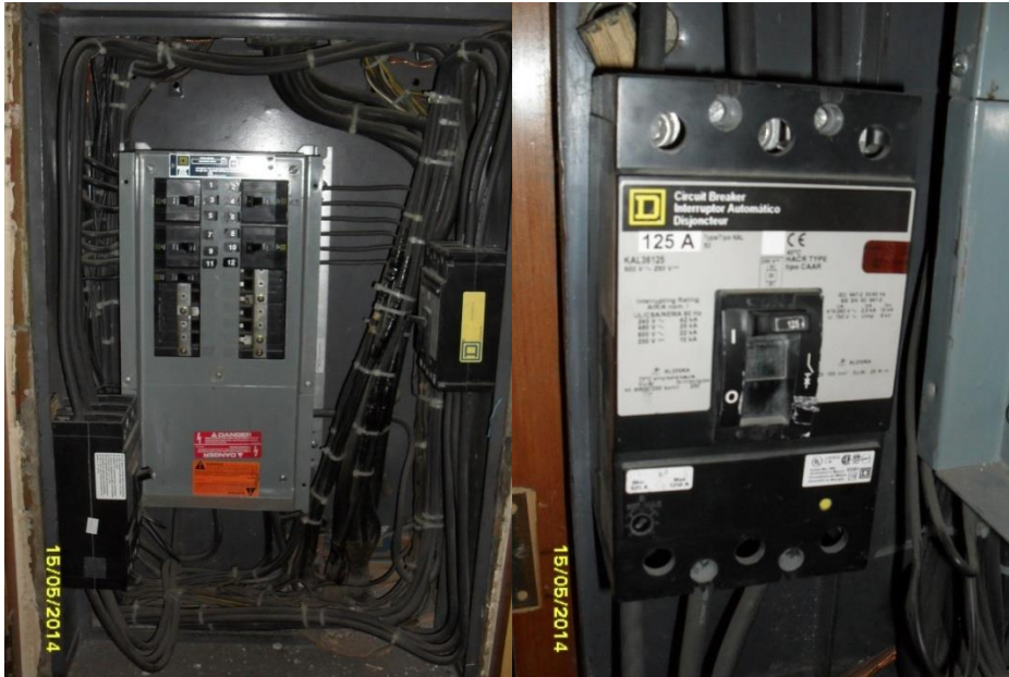
Imagen 2.48 y 2.49 tablero e interruptor 3A
