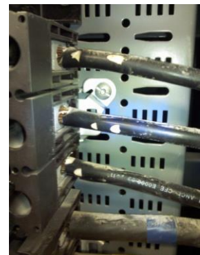
Imagen 2.14 Daño en aislamiento
