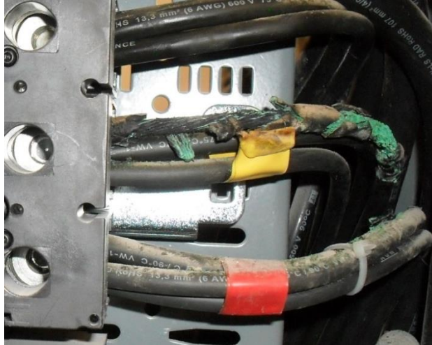
Imagen 2.12 Daño en conductores.
