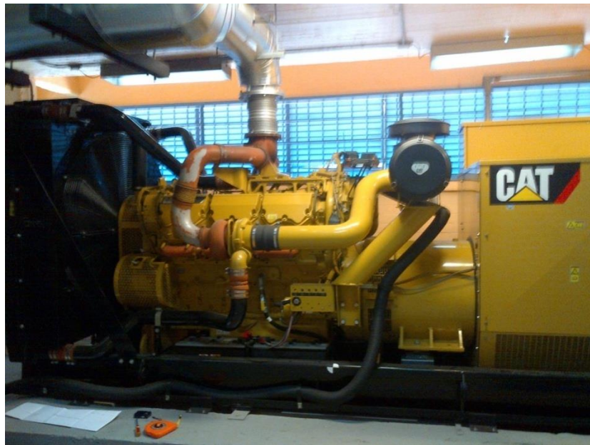
Imagen 2.8 Planta generadora (emergencia)
