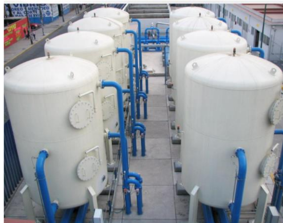
Figura 3.18 Filtros a presión FUENTE: Recuperado del portal ISSUU, presentación “Acueducto Sierra Santa Catarina”, http://issuu.com/iemasee/docs/presentacion_santacatarina
