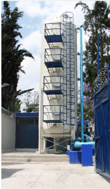
Figura 3.70 Torre de filtros a presión
