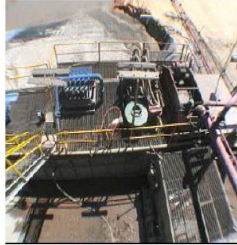
Sistema de lodo
