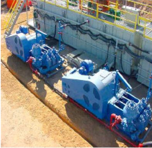
Bombas de lodo
