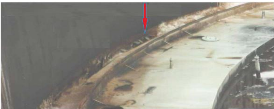
Figura 41. Incendio por Fallas en el Sello del Tanque.
