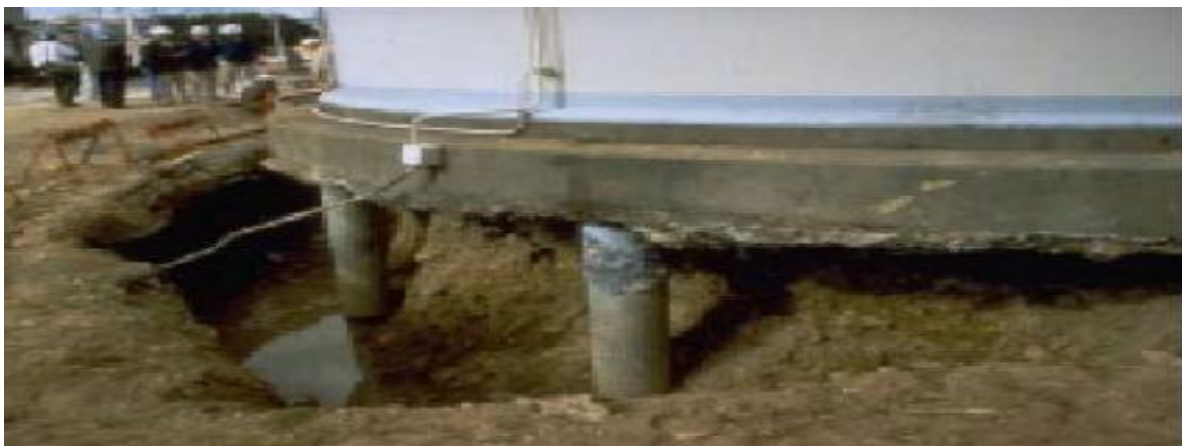
Figura 34. Asentamiento del Suelo.
