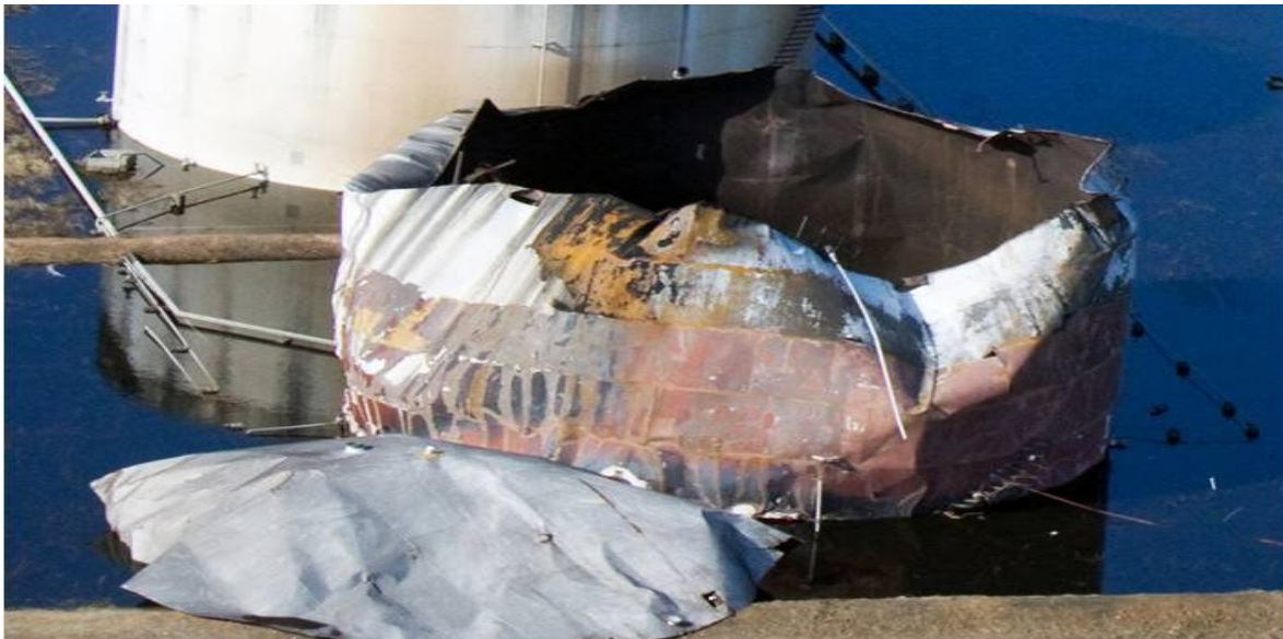
Figura 35. Desprendimiento Techo- Envolvente.
