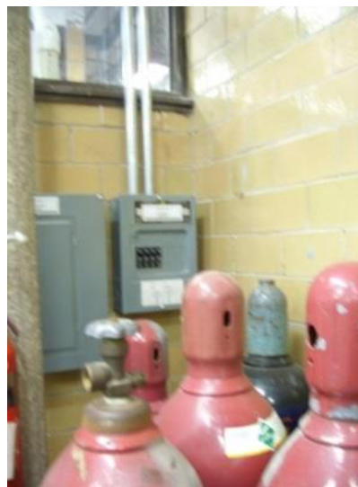
Imagen 3: Centros de Carga obstruidos.
