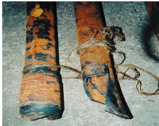
Fig. 3. 29 Agrietamiento de la tubería por H 2 S.
