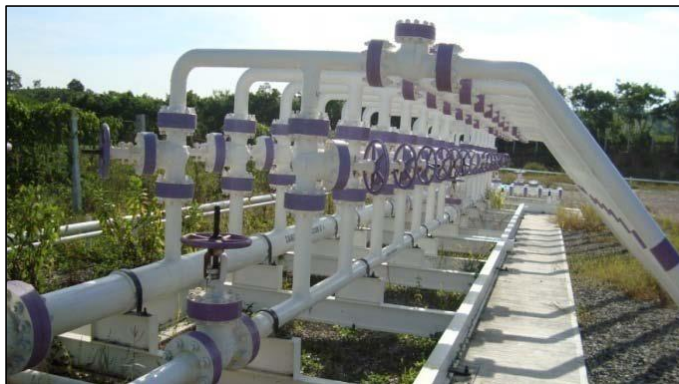
Figura 5.18. MSP - Cabezal colector (Academia de Ingeniería A.C, 2011).
