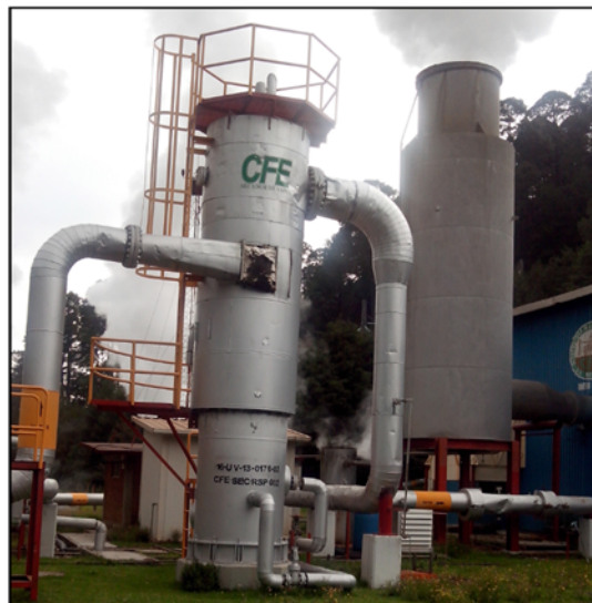
Figura 3.31 Separador de vapor de la central geotermolétrica Los Azufres.
