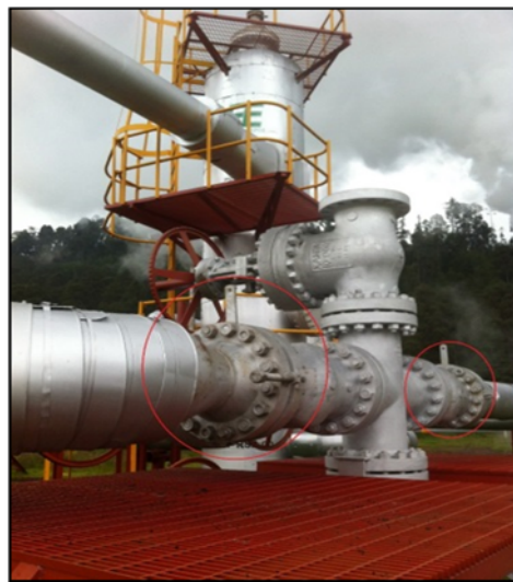
Figura 2.11 Placas orificio instaladas en boca de pozo.
