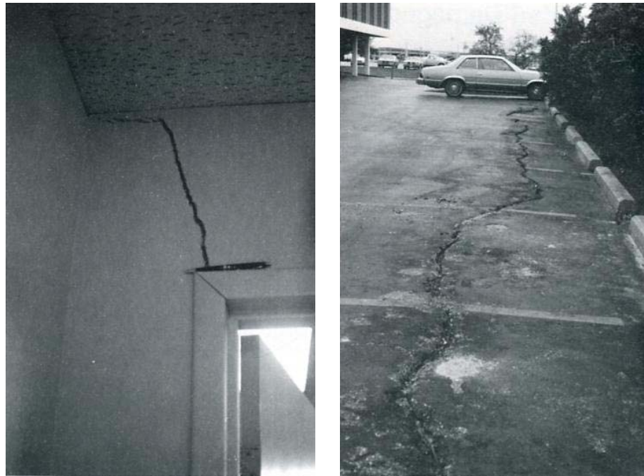
Fig. A.1 Daños típicos a los muros del edificio y al pavimento del estacionamiento.
