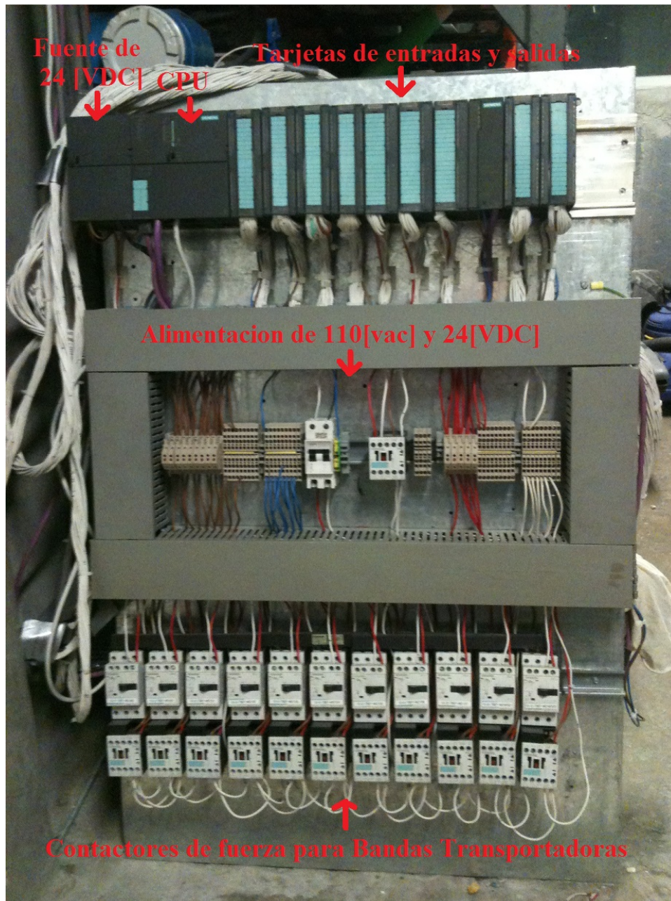
Figura 3.58.- Imagen general del PLC (Alimentación, módulos de entradas y salidas, contactores y comunicación PROFIBUS).
