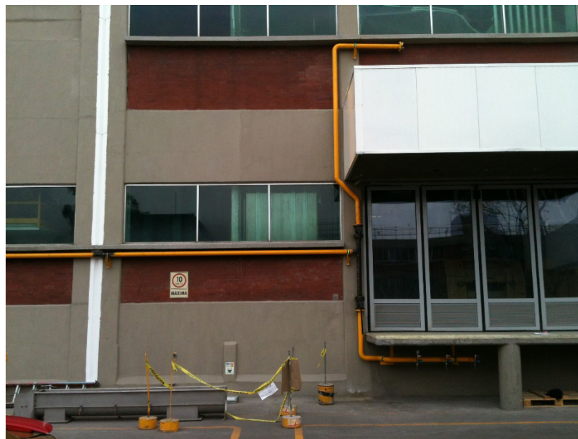
Figura 3.49.- Punto final de la trayectoria de la tubería (fachada principal del molino)
