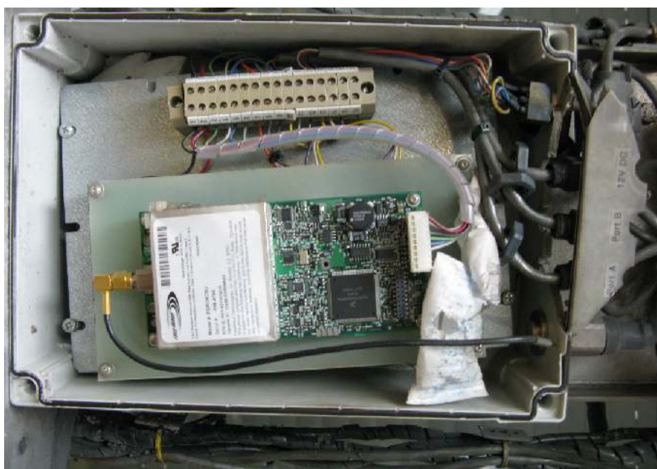
Figura 4.1 Radio módem destruido
