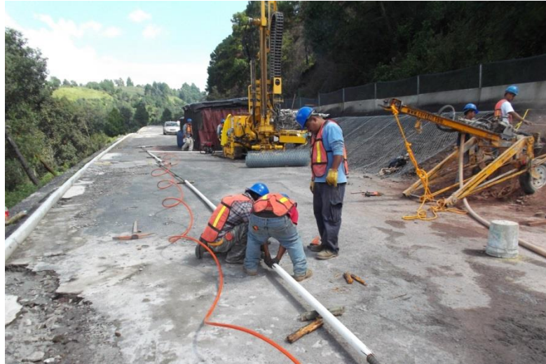
Imagen 11 Habilitado de anclas a la par de la perforación de los barrenos
