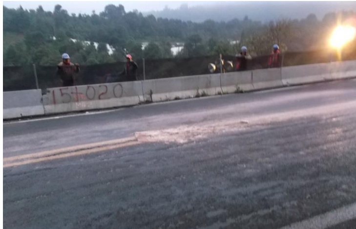
Imagen 25 Fuga de aire y fluido de perforación en el cuerpo de la carretera durante los trabajos conjuntos
