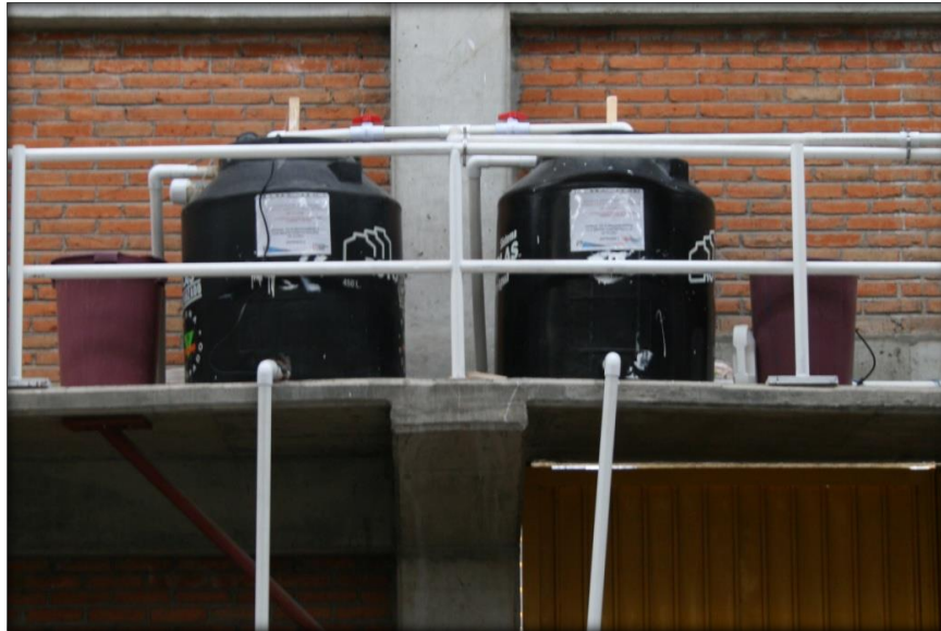
Figura 3.3. Tanques de almacenamiento de 420 litros cada uno.
