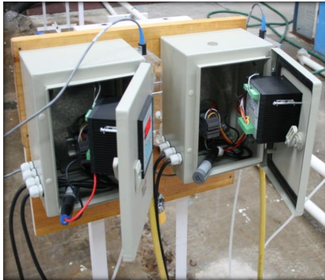
Figura 3.25. Instalación de los data loggers 4 y 5
