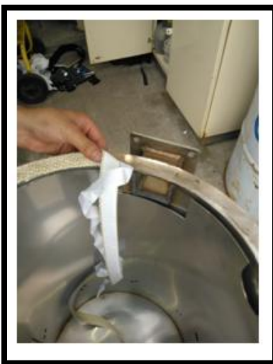
Figura 4.2 Fotografía de la adherencia de junta aislante en reactor
