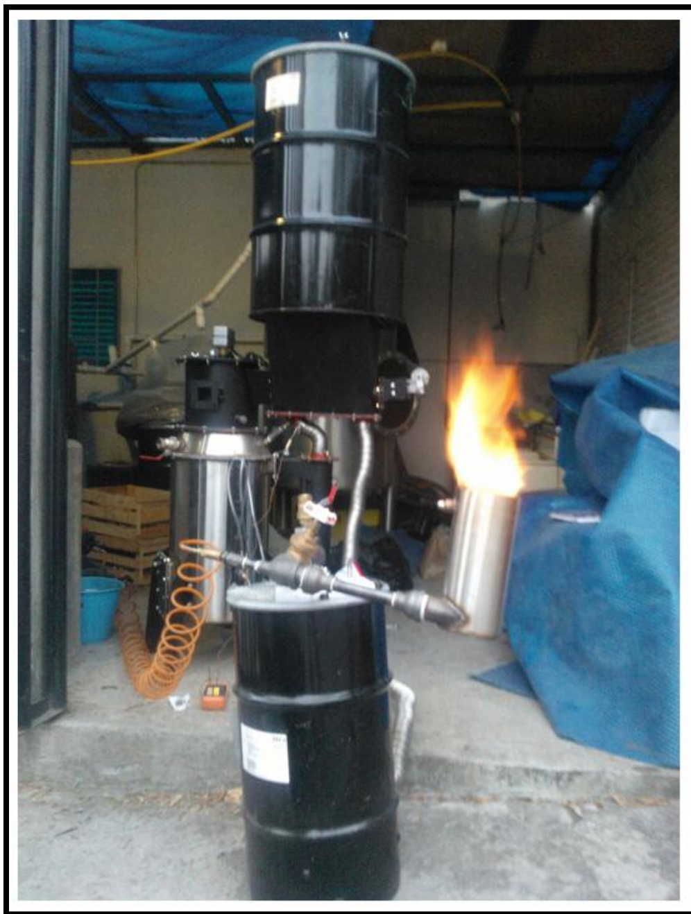
Figura 4.23 Fotografía del gasificador operando
