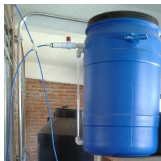
Figura 8. Tanque donde se almacena el agua desionizada en la Planta Solar del II-UNAM.
