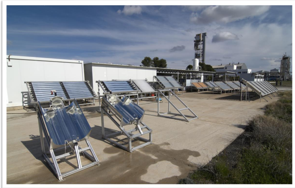
Figura 2. Instalaciones de la Unidad de Tratamiento Solar de Aguas de la Plataforma Solar de Almería (Adaptado de [53]).
