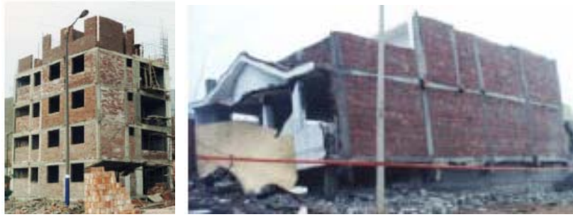
Figura 1.3 Construcciones de viviendas con mampostería, falla de muros de mampostería en un evento sísmico
