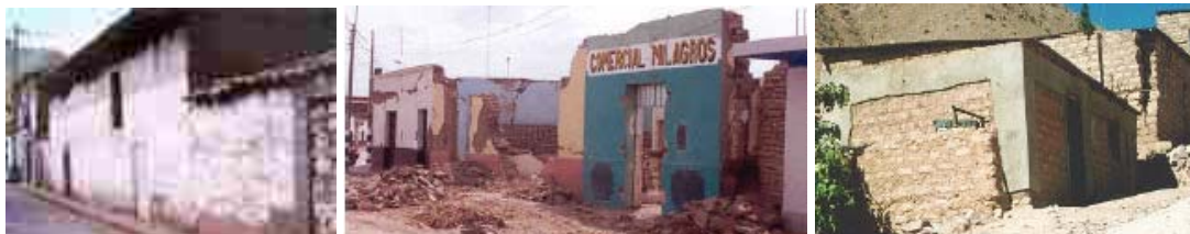
Figura 1.2 Viviendas construidas con adobe, colapso de las viviendas con adobe ante un evento sísmico, reforzamiento de viviendas de adobe.
