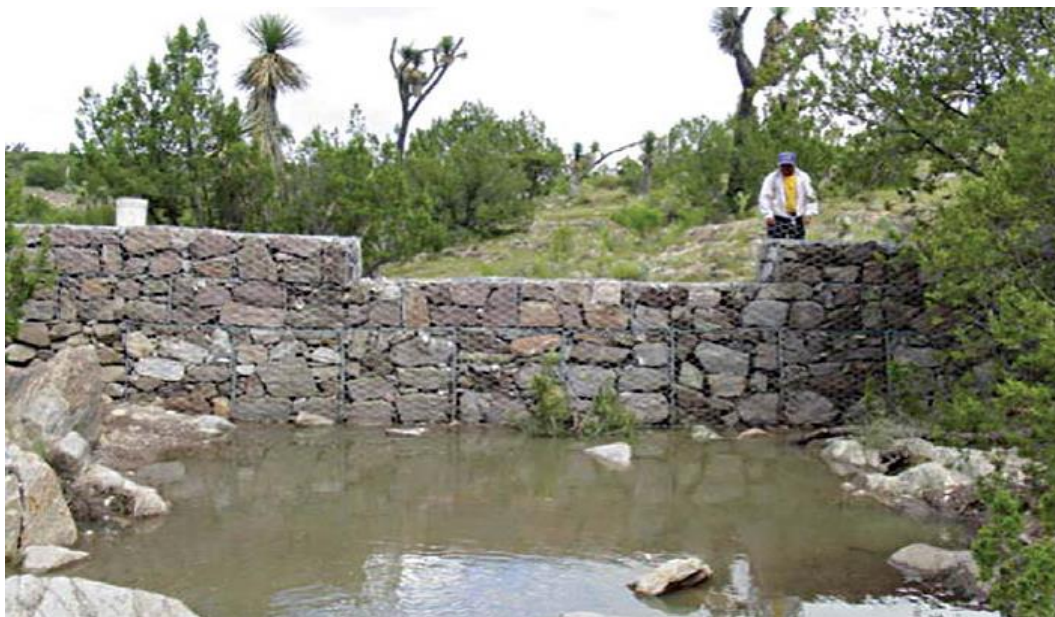
Figura D.29. Presa de gaviones. (Cardoza, et al., 2007).
