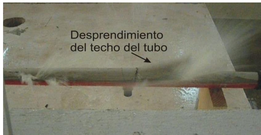
Figura 4.26. Desprendimiento de un fragmento del techo de la tubería, seguido de una importante fuga de agua.
