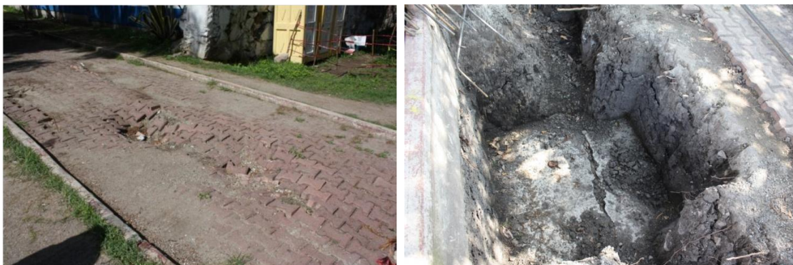
a) b) Figura 5.19. Fallas en el emisor: a) hundimiento en el suelo; b) agrietamiento en la clave del emisor.
