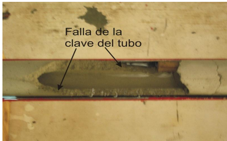
Figura 4.27. Falla del tubo vista en planta.
