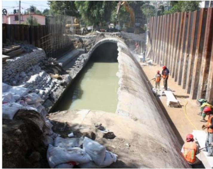
Figura 5.11. Vista general de la sección colapsada.
