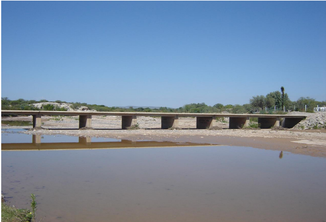
Puente “San Juan de Guadalupe” donde se observa el grado de azolvamiento del cauce.
