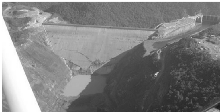
Figura 1.1: Daño en la presa Campos Novos, ubicada sobre el río Canoas, en el estado de Santa Catarina, Brasil [35].
