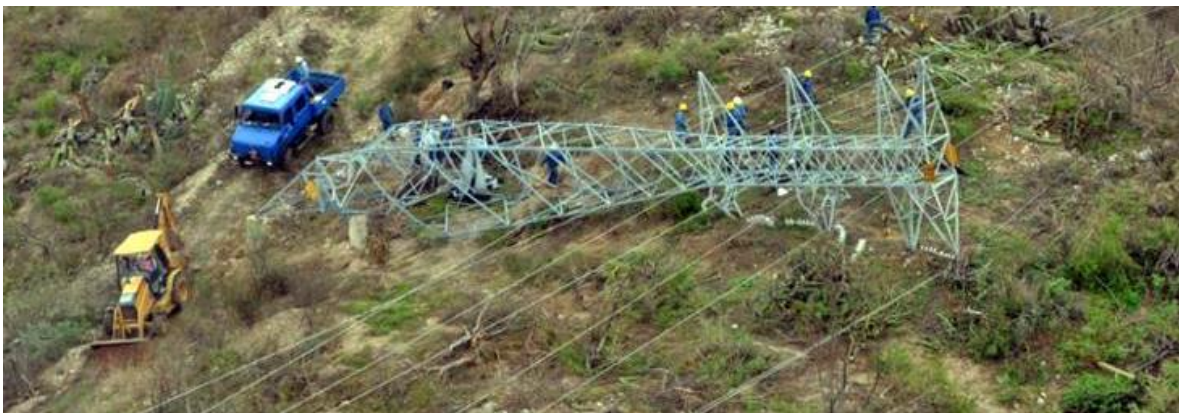
Figura 4. 4 Falla con desplome de la estructura (El Universal, 2014).
