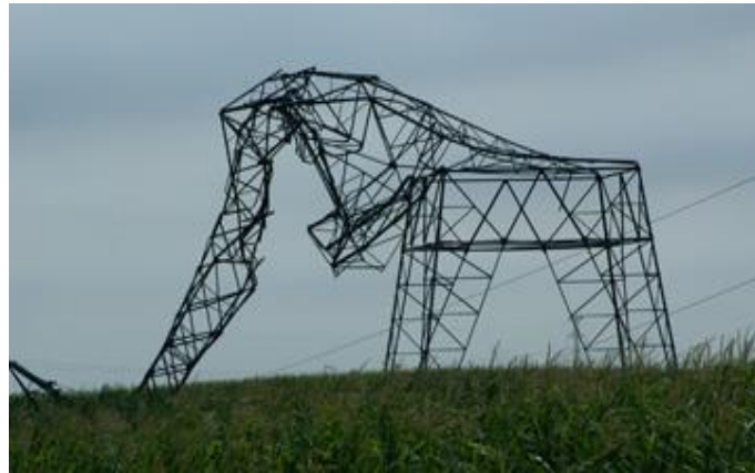
Figura 4. 10 Falla en elementos estructurales por fuerzas de grandes proporciones (Runestone Electric Association, 2011).
