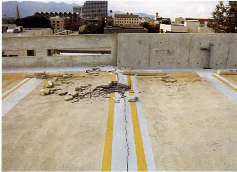
Figura 1.13 Daño en el borde de un tablero prefabricado Northridge 1994
