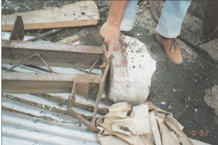
Figura 2. 14 Falla de nave industrial debido a la edad, baja protección al intemperismo (weatherization) y anclaje insuficiente para resistir cargas de levantamiento (FEMA, 1993).
