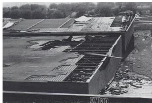
Figura 2. 9 Falla local, desprendimiento de lámina metálica y recubrimiento por sobrepresión negativa (Kumar & James, 1992).
