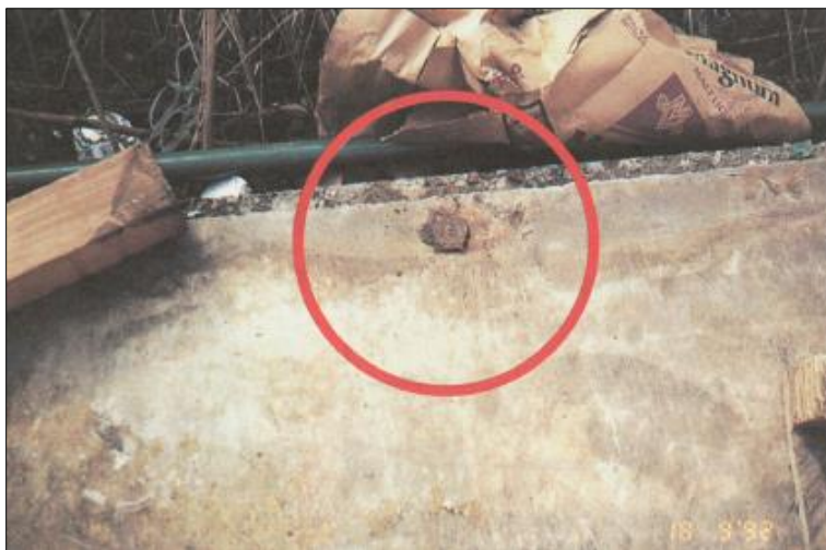
Figura 2. 15 Falla en unión entre el marco de acero y la cimentación de concreto reforzado por falta de anclajes (FEMA, 1993).
