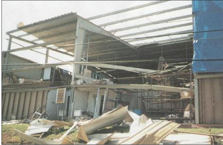
Figura 2. 12 Falla de nave industrial debido a la desprendimiento de la lámina de bajo calibre de la cubierta (FEMA, 1993).
