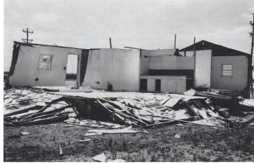
Figura 2. 7 Efectos generales de un flujo de viento alrededor de un edificio de baja altura (Kumar & James, 1992).
