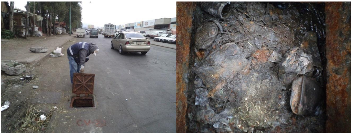
FIGURA A. 16 LA CAJA DE VÁLVULAS CV-21 SE ENCUENTRA TOTALMENTE AZOLVADA Y CON DESECHOS HUMANOS
