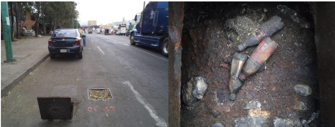
FIGURA A. 15 LA CAJA DE VÁLVULAS CV-32 SE ENCUENTRA TOTALMENTE AZOLVADA Y CON DESECHOS HUMANOS
