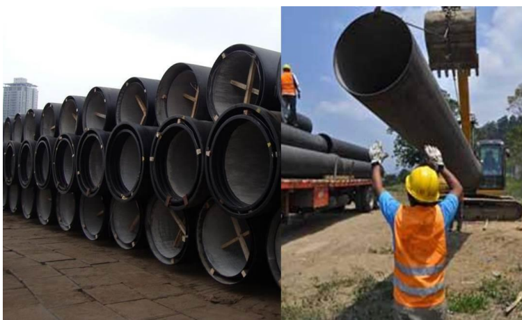
FIGURA 1. 9 TUBERÍA DE HIERRO DÚCTIL
