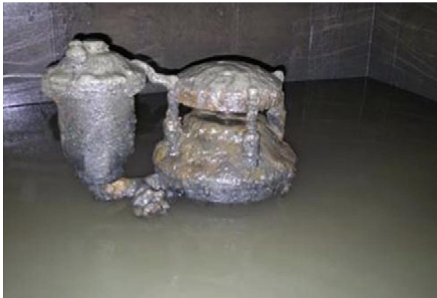
FIGURA 4. 4 CAJA DE VÁLVULAS INUNDADA CON AGUA CONTAMINADA
