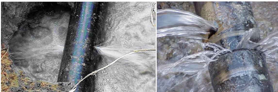
FIGURA 4. 10 TUBERÍAS CON FALLOS DE TIPO ORIFICIO
