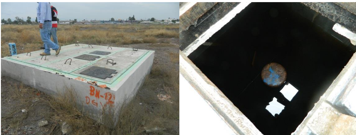
FIGURA A. 5 CAJA DE VÁLVULAS CON UNA VÁLVULA DE ADMISIÓN Y EXPULSIÓN DE AIRE INUNDADA CON UN TIRANTE DESDE EL FONDO DE LA CAJA DE 1.95 M. EL AGUA ES PRODUCTO DE LA EXPULSIÓN DE AGUA DE LA VÁLVULA Y DADO QUE NO TIENE COMO DRENARSE, SE HA INUNDADO
