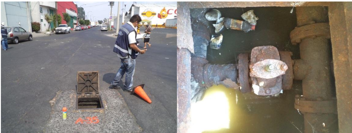
FIGURA A. 12 LA CAJA DE VÁLVULAS A-35 SE ENCUENTRA INUNDADA CON UN TIRANTE DE 0.60 M
