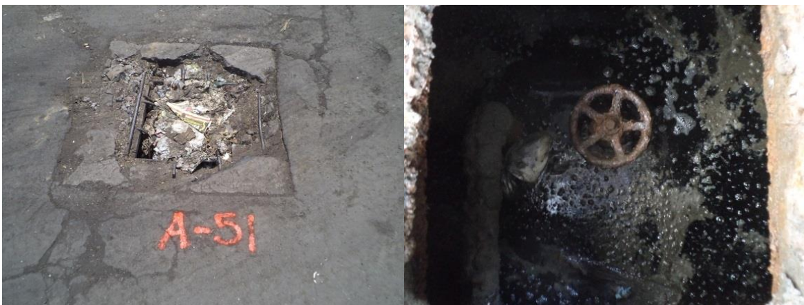
FIGURA A. 13 LA CAJA DE VÁLVULAS A-51 SE ENCUENTRA INUNDADA CON UN TIRANTE DE 0.80 M
