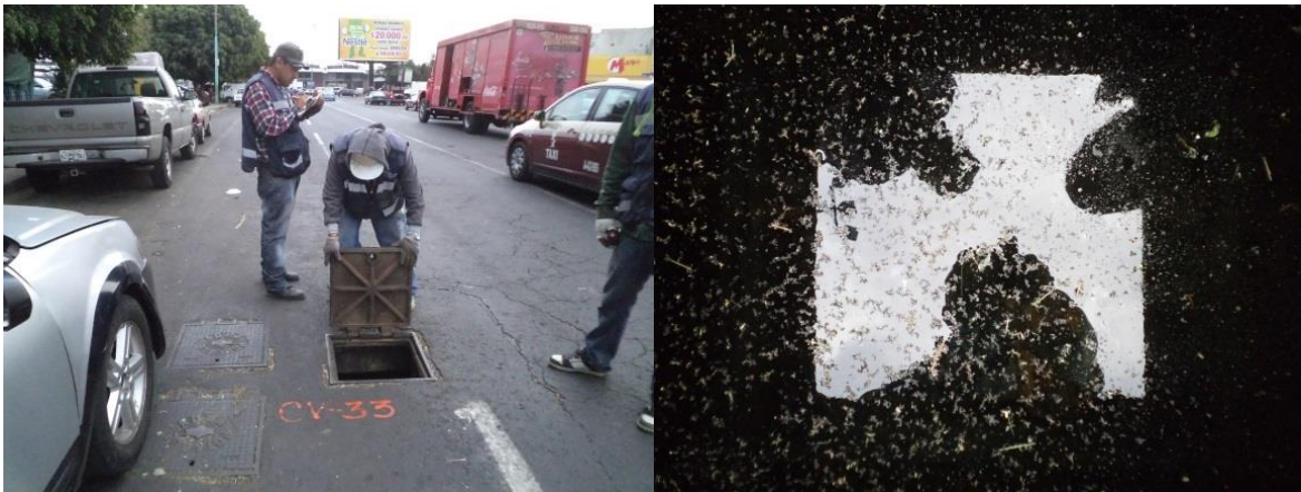
FIGURA A. 10 LA CAJA DE VÁLVULAS CV-33 SE ENCUENTRA COMPLETAMENTE INUNDADA CON PROFUNDIDAD APROXIMADA DE 1.5 M
