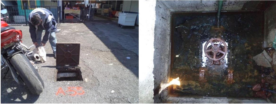
FIGURA A. 17 LA CAJA DE VÁLVULAS A-53 SE ENCUENTRA INUNDADA CON GRASA CON UN TIRANTE DE 0.65 M
