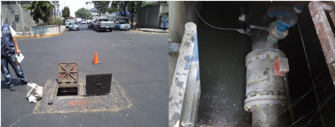
FIGURA A. 9 LA CAJA DE VÁLVULAS A-27 SE ENCUENTRA INUNDADA CON UN TIRANTE DE 0.70 M, SE ENCUENTRA UNA VÁLVULA ANTIRETORNO DE SOLENOIDE Y UNA VÁLVULA DE ADMISIÓN Y EXPULSIÓN DE AIRE. LA CAJA REGULARMENTE SE SATURA Y DESBORDA
