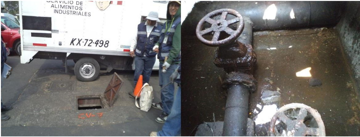
FIGURA A. 8 LA CAJA DE VÁLVULAS CV-7 SE ENCUENTRA LLENA DE LÍQUIDOS EN ESTADO DESCOMPOSICIÓN
