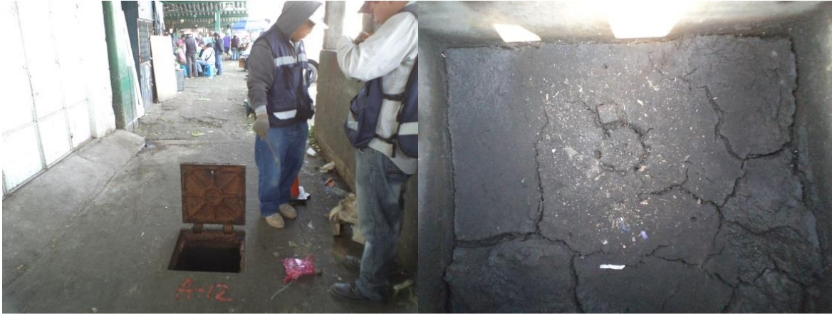
FIGURA A. 11 LA CAJA DE VÁLVULAS A-12 SE ENCUENTRA AZOLVADA EN UNA MATRIZ DE SUELO CONTAMINADO
