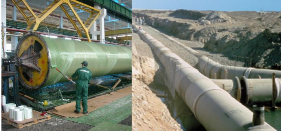
FIGURA 1. 10 TUBERÍA DE FIBRA DE VIDRIO
