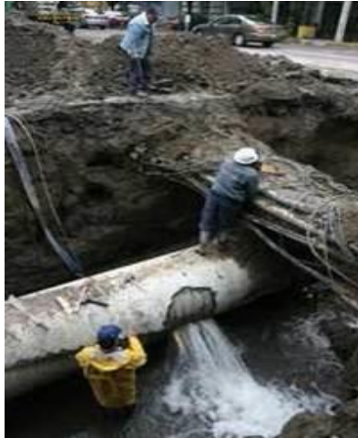
FIGURA 4. 5 RUPTURA EN LÍNEA DE CONDUCCIÓN DE AGUA POTABLE CON DESCARGA EN LA MATRIZ DEL SUELO.
