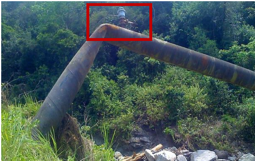
FIGURA 3. 2 FALLA DE TUBERÍA DE ACERO HELICOIDAL PRÓXIMA A LA UBICACIÓN DE UNA VÁLVULA DE EXPULSIÓN DE AIRE
