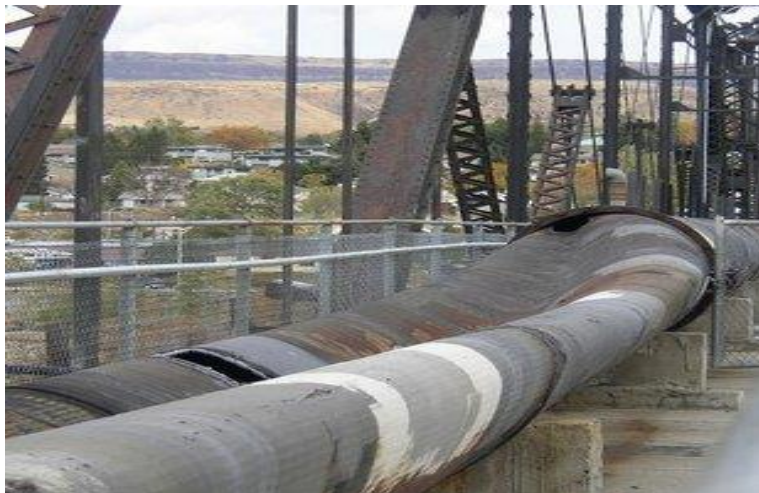
FIGURA 3. 1 TUBERÍA DE ACERO HELICOIDAL CON FALLA POR APLASTAMIENTO
