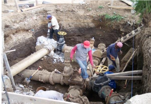
FIGURA 1. 15 CRUCERO DE TUBERÍA DE AGUA POTABLE
