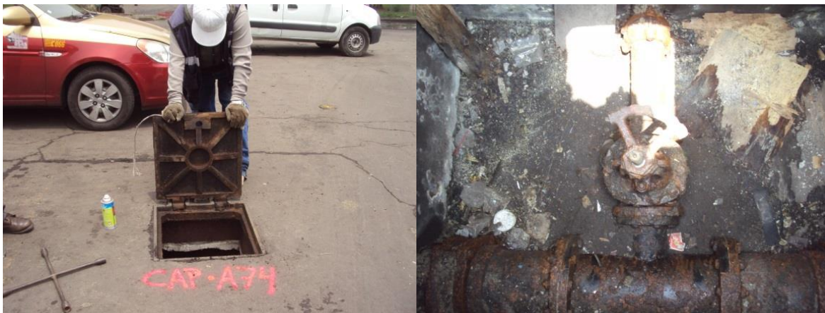
FIGURA A. 7 LA CAJA DE VÁLVULAS CAP-A74 SE ENCUENTRA LLENA DE MATERIA ORGÁNICA EN ESTADO DESCOMPOSICIÓN
