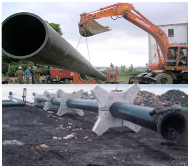
FIGURA 1. 8 TUBERÍA DE PAD
