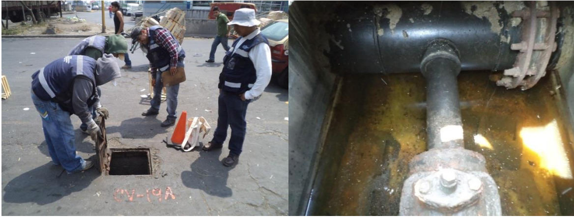
FIGURA A. 14 LA CAJA DE VÁLVULAS CV-19A SE ENCUENTRA INUNDADA CON GRASA CON UN TIRANTE DE 0.25 M
