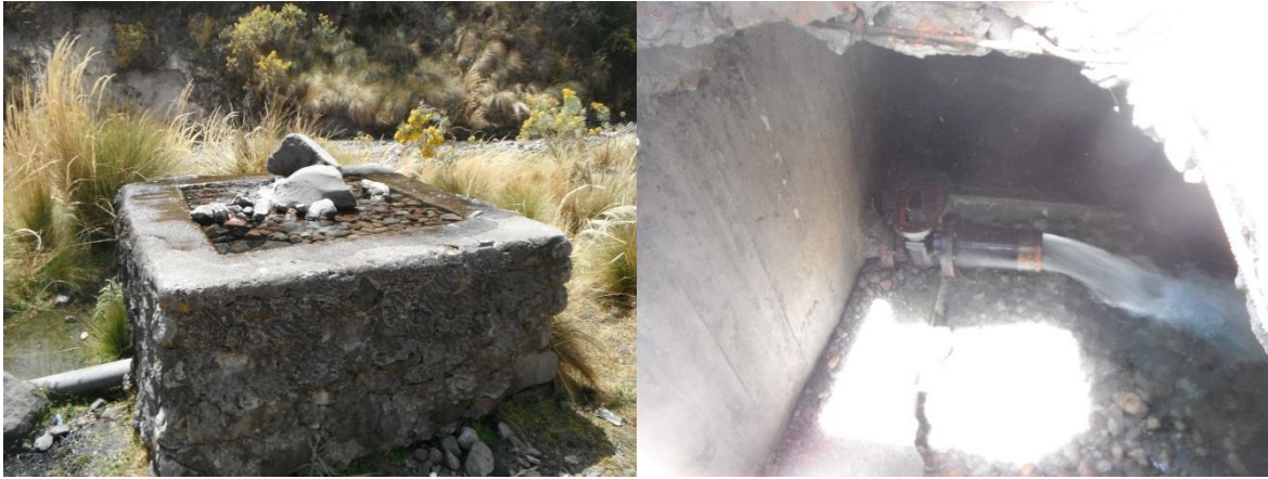
FIGURA A. 3 CAJA DE VÁLVULAS LLENA DE AGUA A TAL GRADO QUE LEVANTA LA TAPA; LA POBLACIÓN COLOCA PIEDRAS ENCIMA DE LA TAPA PARA EVITAR QUE SE DESPLACE. LLEGADA DE LA LÍNEA DE CONDUCCIÓN AL TANQUE DE ALMACENAMIENTO
