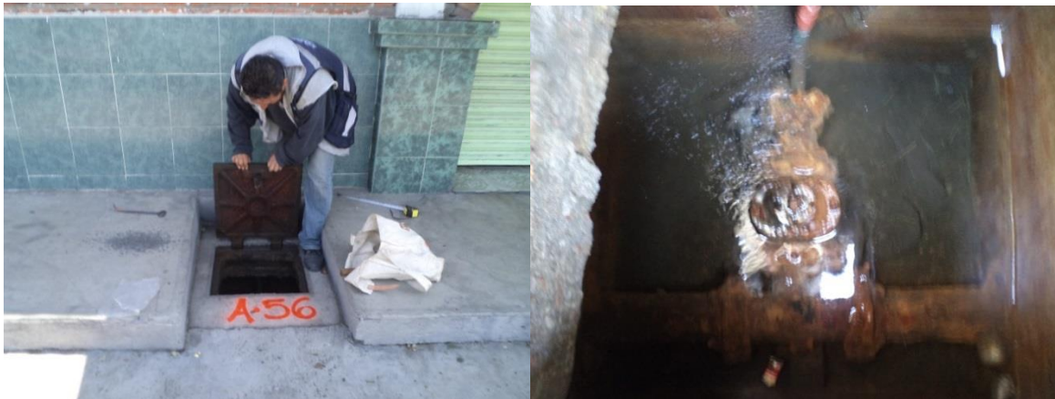
FIGURA A. 18 LA CAJA DE VÁLVULAS A-56 SE ENCUENTRA INUNDADA CON GRASA CON UN TIRANTE DE 0.55 M
