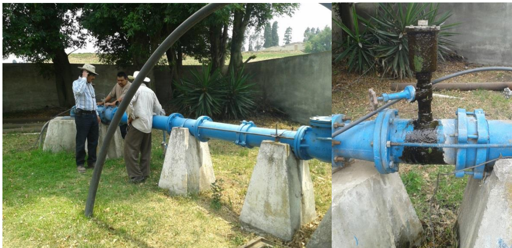
FIGURA A. 1 OBRA DE TOMA DE POZO DE BOMBEO CON VÁLVULA DE ADMISIÓN Y EXPULSIÓN DE AIRE CON FUGAS Y LLENA DE HONGOS
