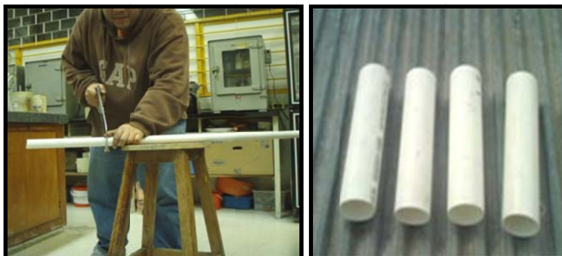
Figura A3-2. Corte de tubo de PVC para la elaboración de los difusores de alimentación y colectores de agua tratada.
